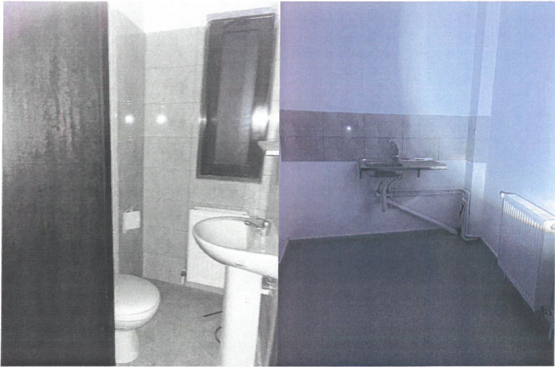
Obiecte sanitare montate la grupurile sanitare și zona de preparare/ oficiu.
