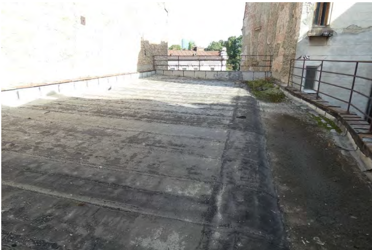
Foto 10 – Invelitoarea bituminoasa a acoperisului terasa degradata. Portiuni unde apa stagneaza cu acumulari locale de reziduuri
