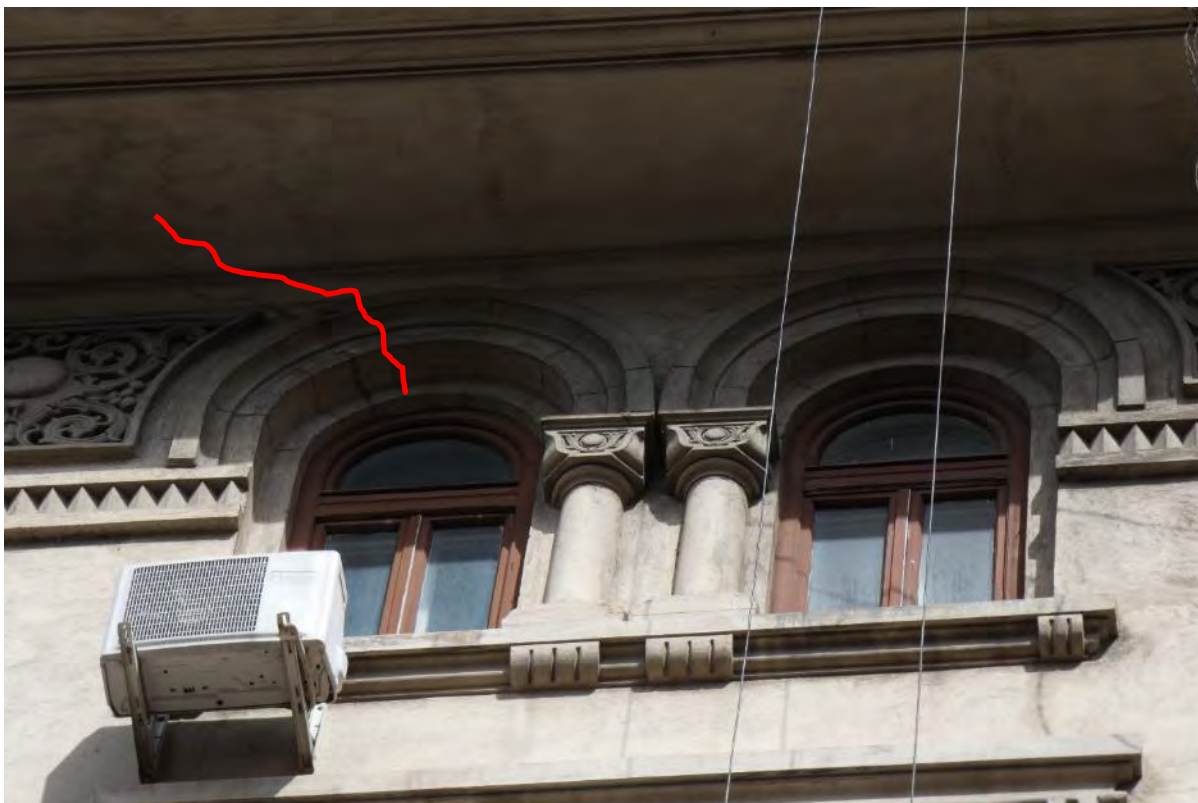
Foto 04 – Fractura in dreptul arcului golului de fereastră
