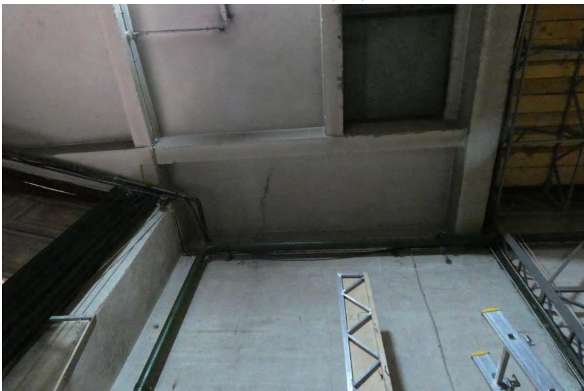
Foto 06 – Fractura in dreptul planseului din beton armat de peste parter
