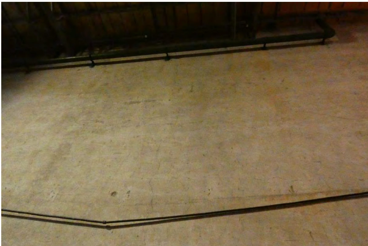
Foto 05 – Fracturi verticale in plinul peretelui
