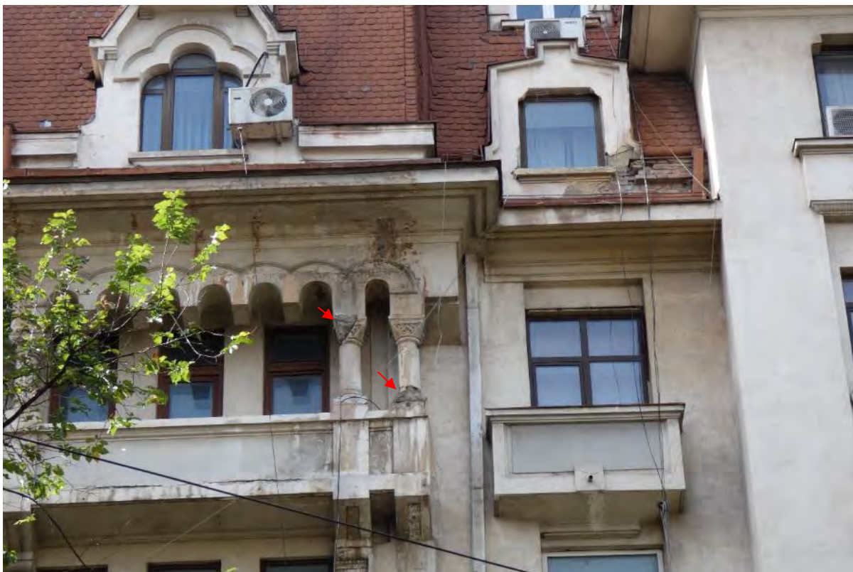
Foto 12 – Avarii la nivelul stalpisorilor din dreptul balconului. Tencuieli masive in pericol de cadere. Infiltratii de umiditate si fracturi in cornisa de peste balcon
