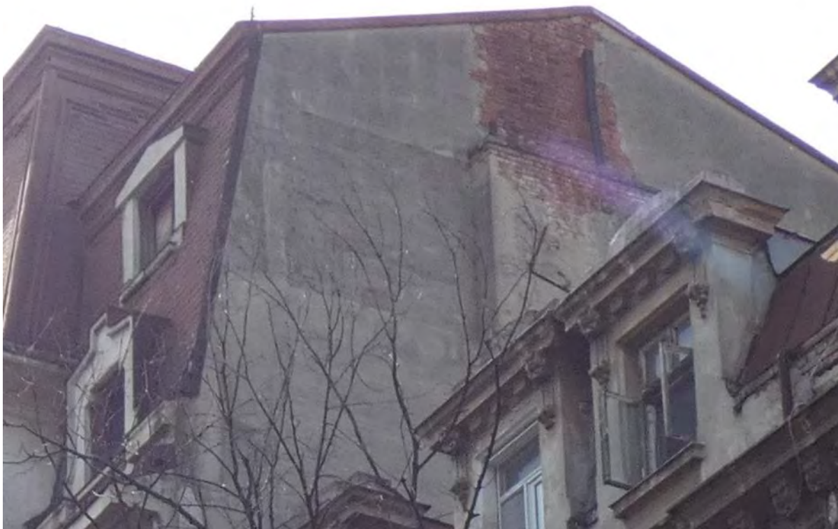
Foto 11 – Tencuieli degradate in dreptul calcanului de la aripa vestica a tronsonului A. zidaria ultimului nivel fara elemente de confinare din beton armat
