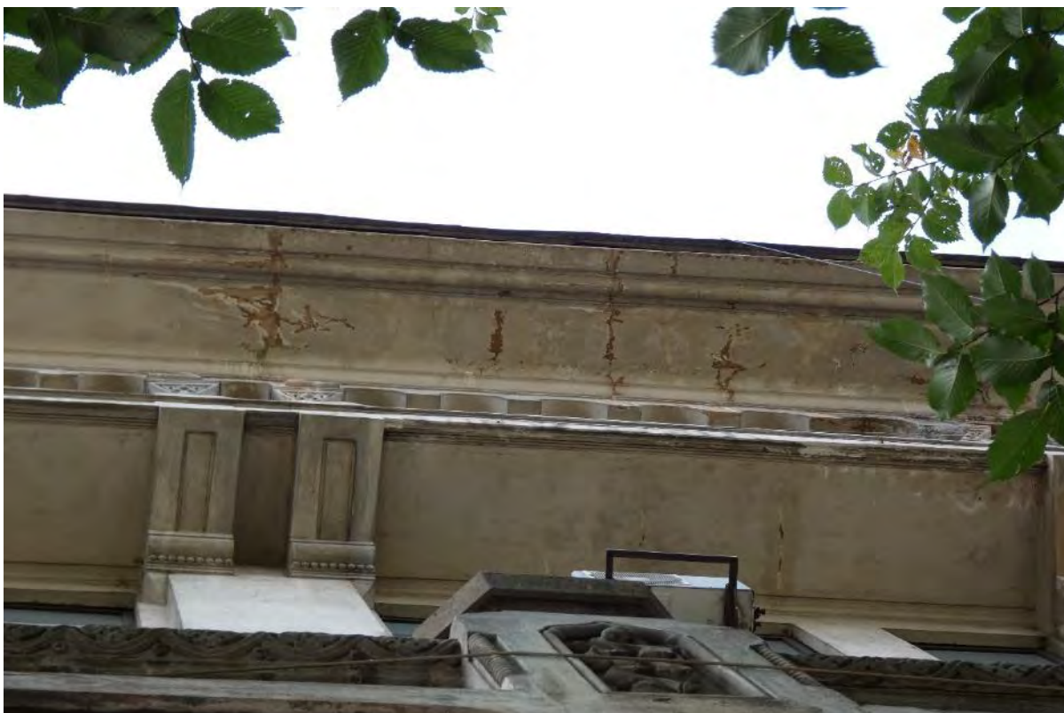
Foto 09 – Crapaturi multiple in dreptul placii balcoanelor si in dreptul cornisei de la partea superioara a peretilor
