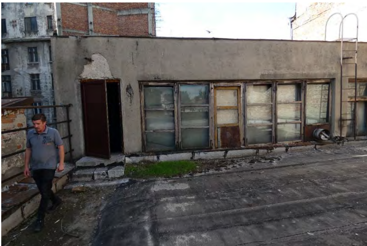
Foto 11 – Acces acoperis terasa – vedere de ansamblu. Tencuieli degradate
