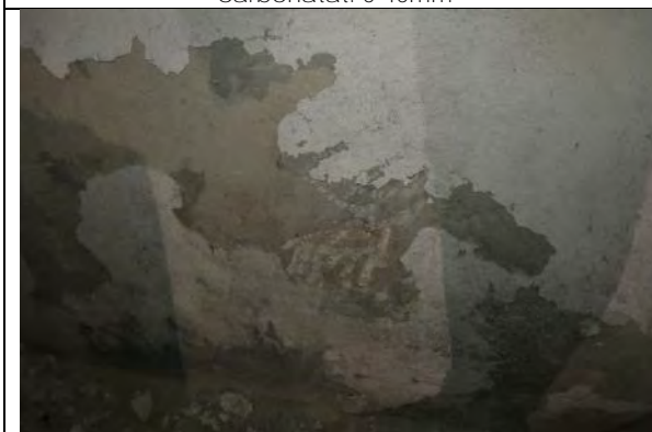
Incercarea ALC13 perete - grosime strat beton carbonatat: 0-50mm
