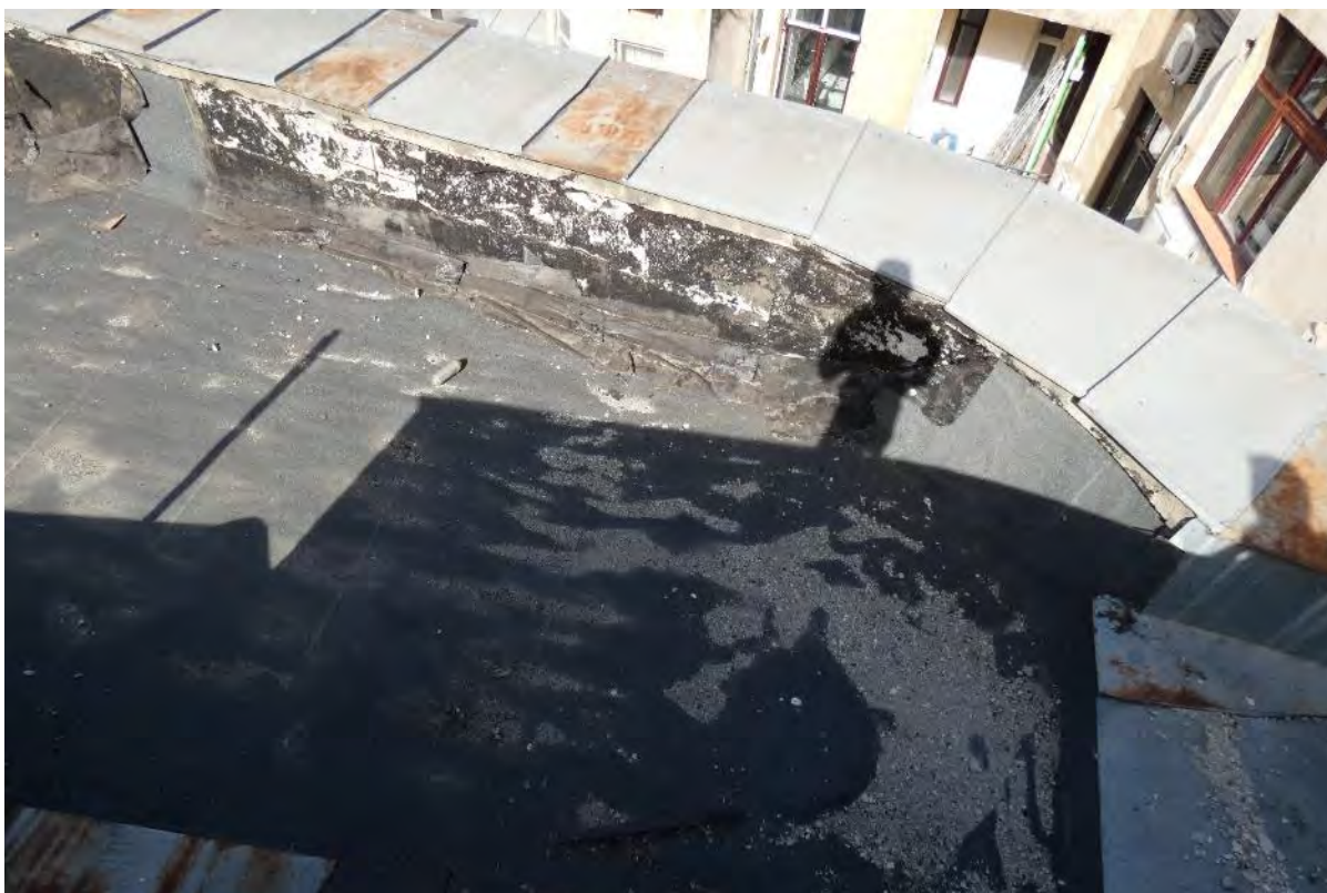
Foto 05 – Degradari in dreptul invelitorii bituminoase de la nivelul acoperisului terasa
