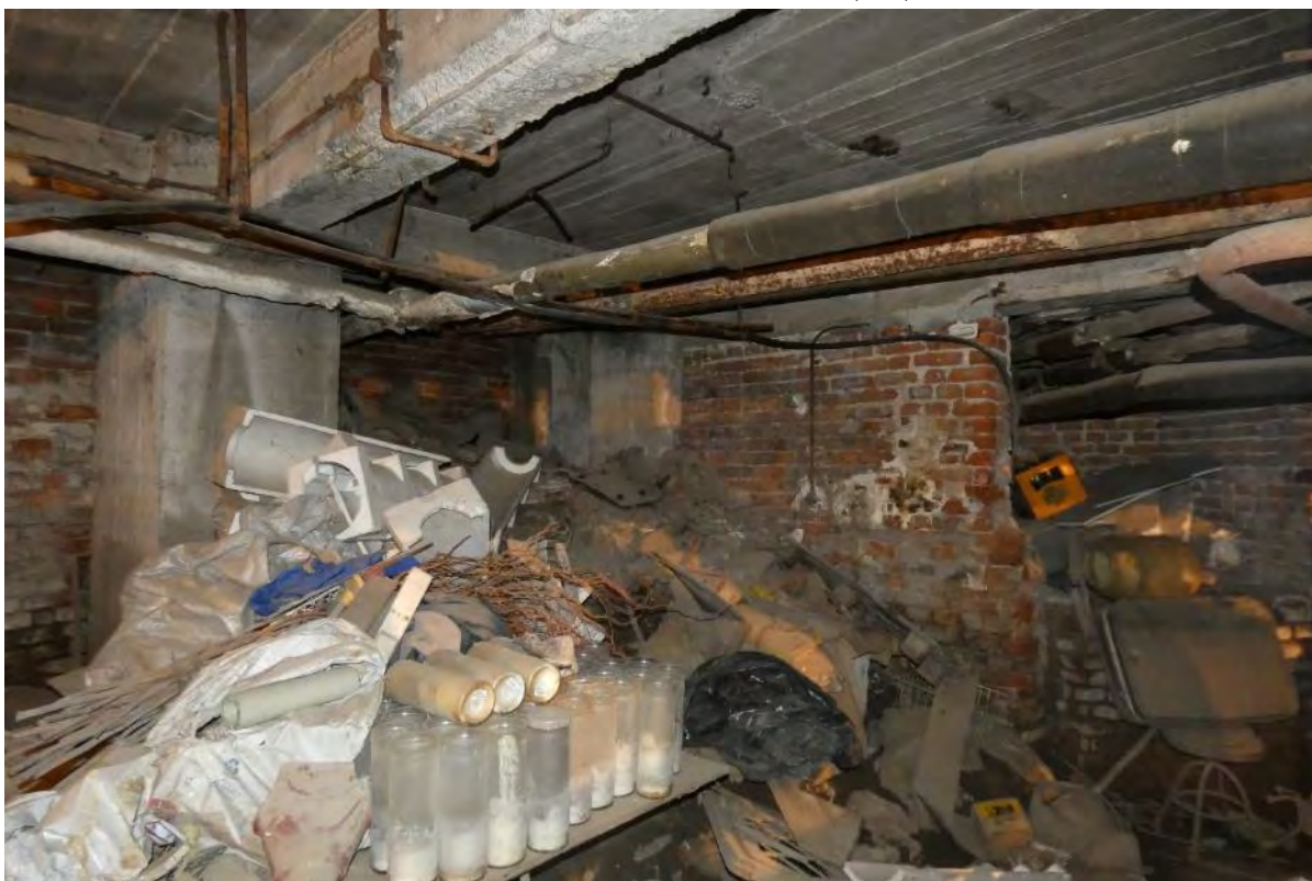
Foto 26 – Armarea transversala a grinzilor de cadru neconforma (pas etrieri). Acoperire cu beton insuficienta
