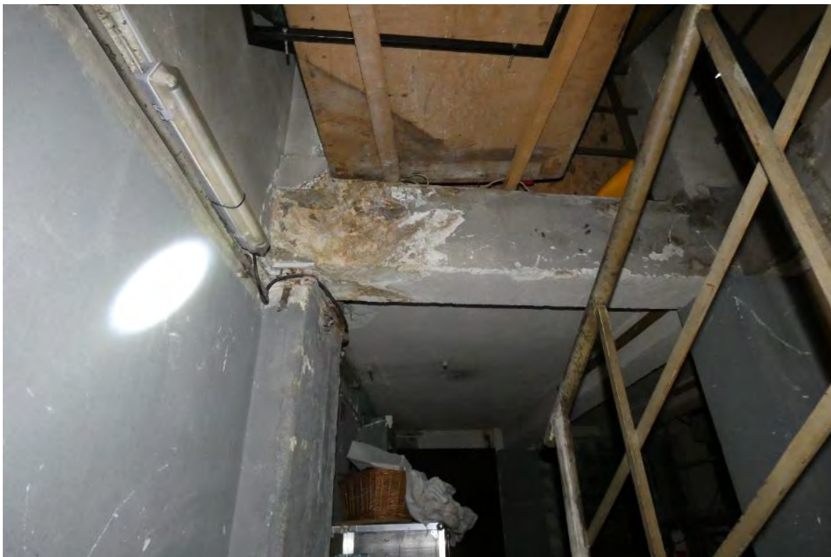
Foto 08 – Infiltratii semnificative de umiditate
