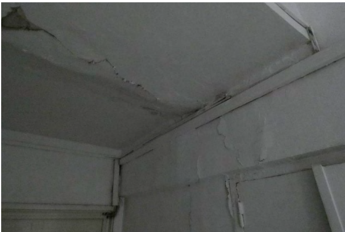
Foto 11 – Degradari in dreptul peretilor si al planseului in zona de rost dintre tronsoanele B si C
