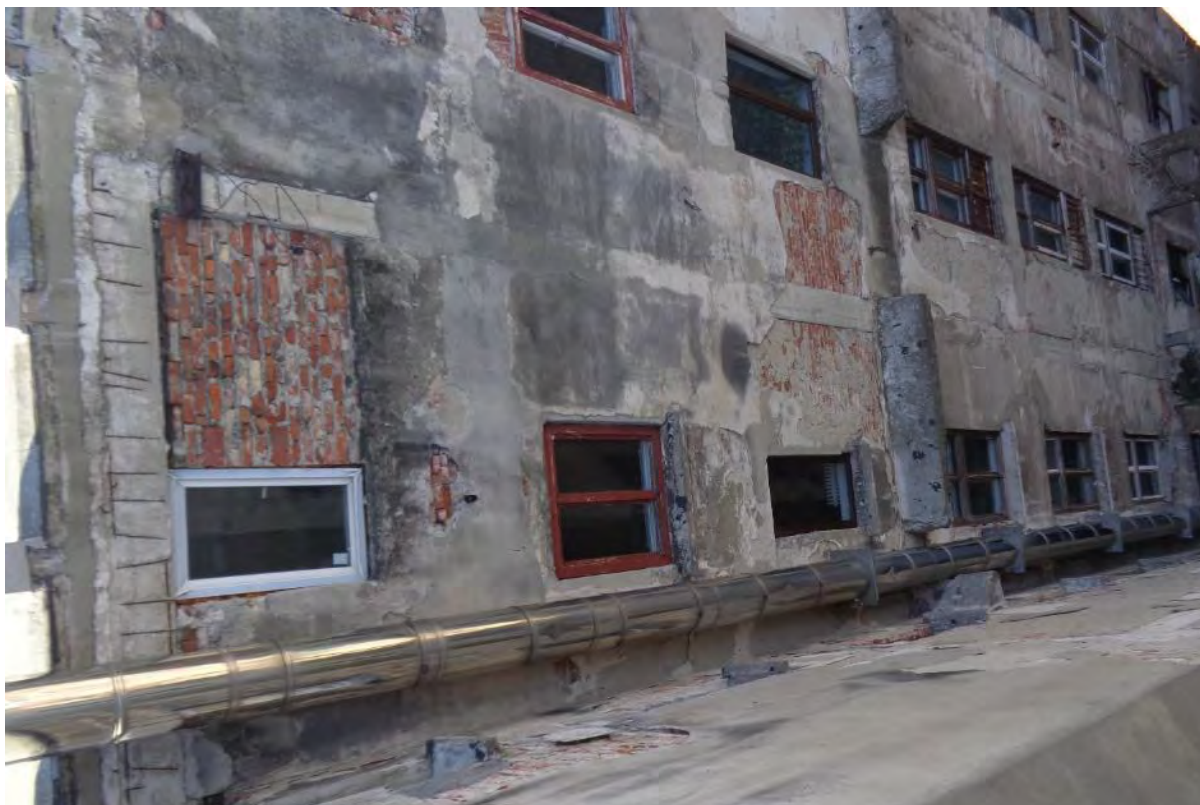
Foto 16 – Avarii in dreptul peretelui exterior al curtii interioare de pe aripa estica. Tencuieli avariate in pericol de cadere. Elemente din beton armat friabilizate in masa
