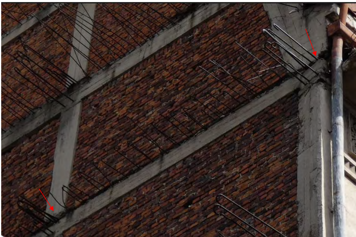
Foto 06 – Rosturi de turnare neconforme. Elementele din beton armat prezintă abateri semnificative la un nivel la altul
