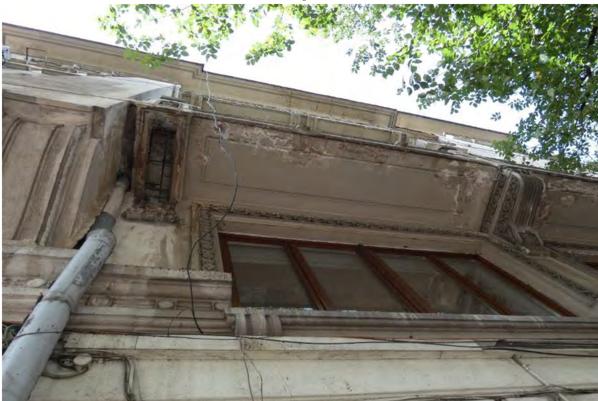
Foto 08 – Avarii la intradosul balcoanelor. Infiltratii de umiditate
