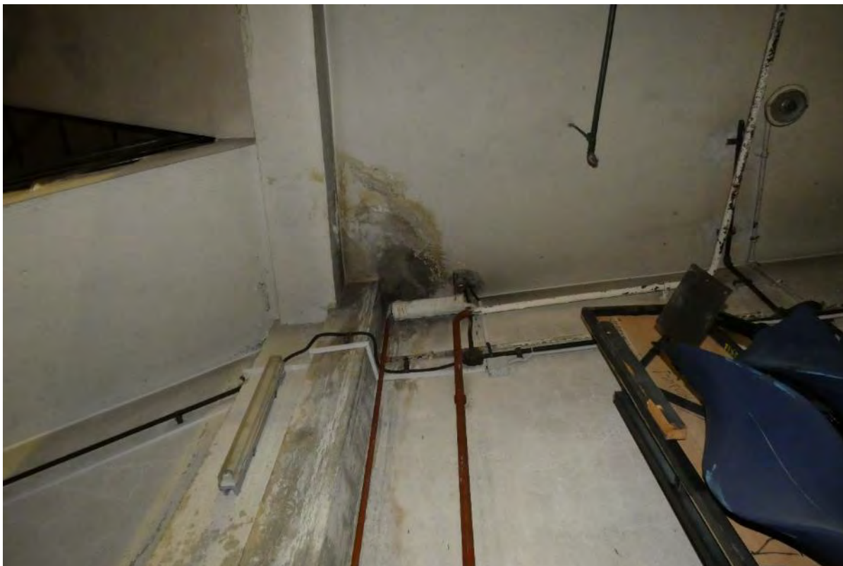
Foto 07 – Infiltratii de umiditate in dreptul planseului de peste parter si in dreptul peretelui interior
