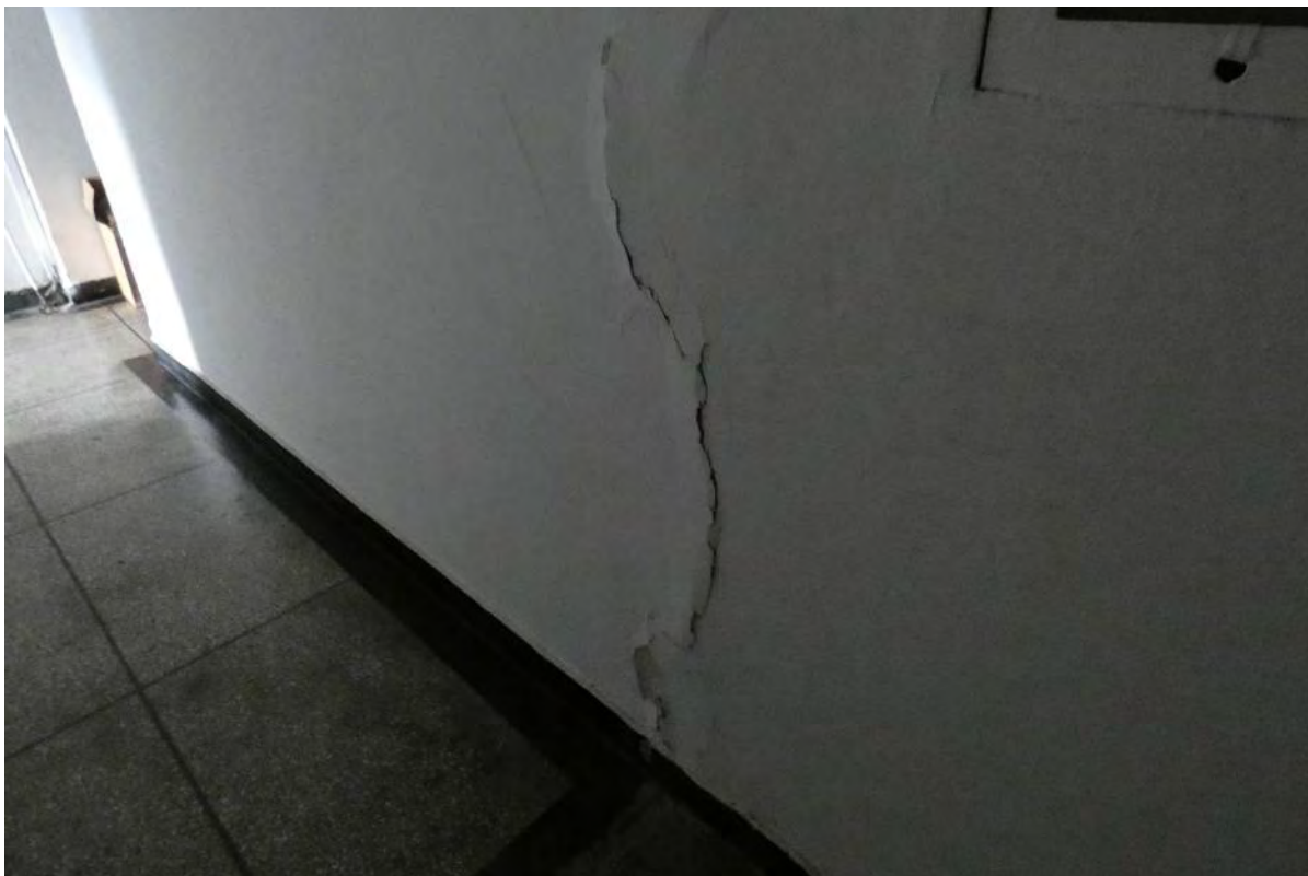
Foto 08 – Degradari severe in zona de rost dintre tronsoanele B si C in dreptul peretilor
