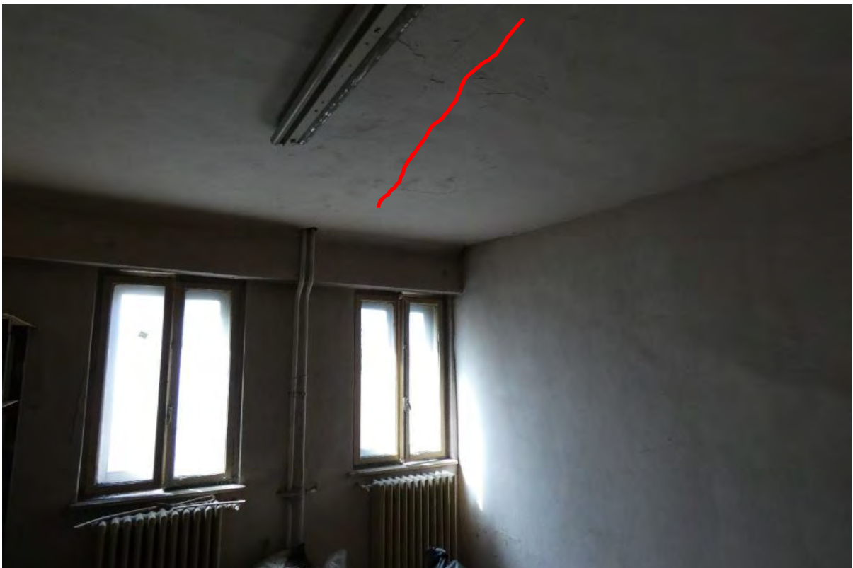
Foto 30 – Fisuri transversale in placa plaseului peste etajul 3
