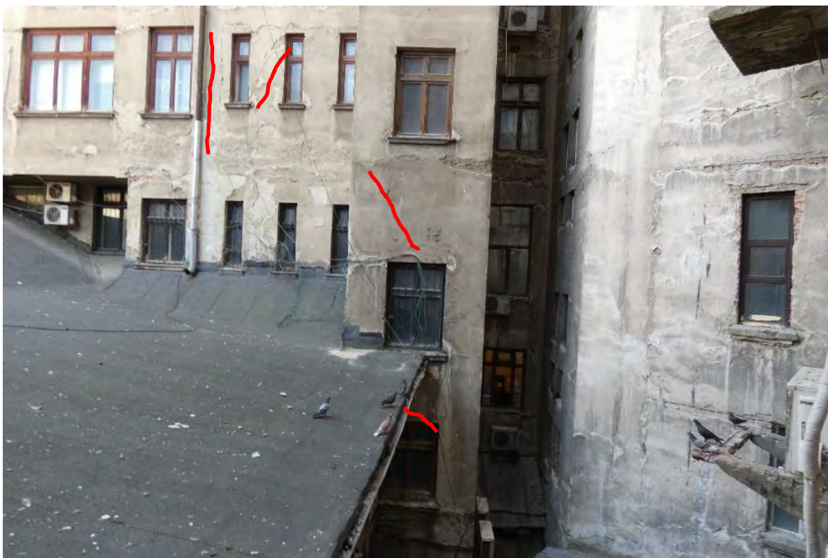
Foto 21 – Fracturi inclinate si verticale in dreptul peretilor exteriori
