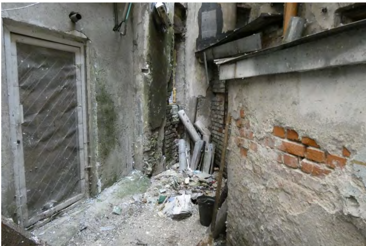
Foto 19 – Avarii in dreptul stalpilor din beton armat la baza
