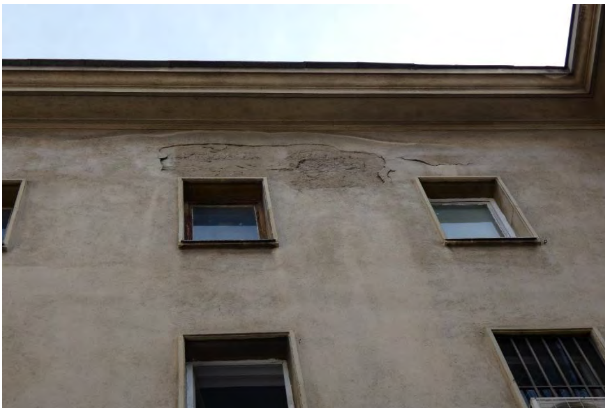
Foto 09 – Tencuieli degradate la partea superioara a peretilor
