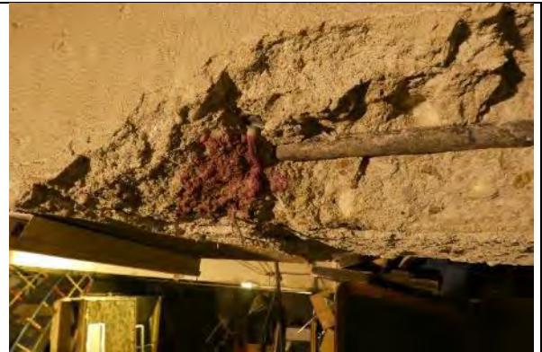
Inercarea ALC18 grinda - grosime strat beton carbonatat: 0-30mm
