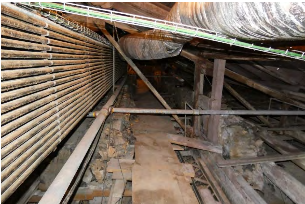
Foto 06 – Vedere de ansamblu structura metalica acoperis (grinda cu zabrele). Elementele din metal corodate
