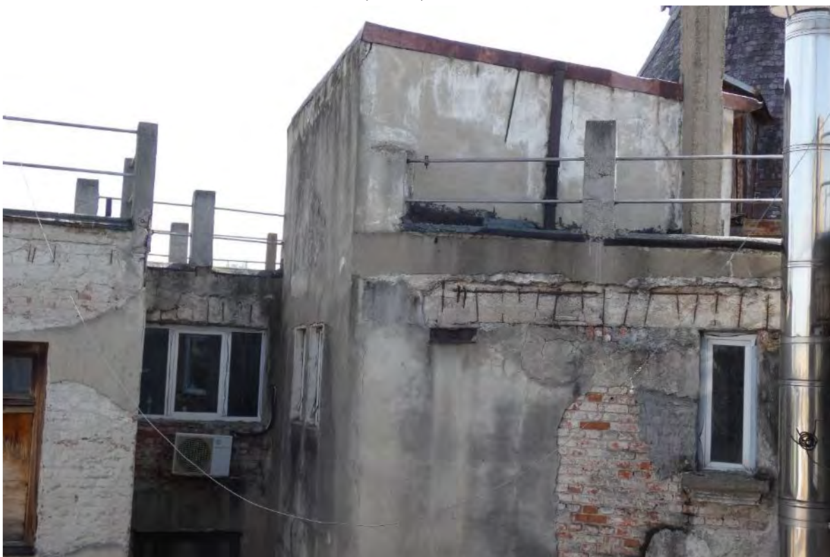
Foto 20 – Tencuielei degradate in pericol de cadere. Avarii in dreptul elementelor din beton armat existente (armaturi corodate in procent de peste 90%)
