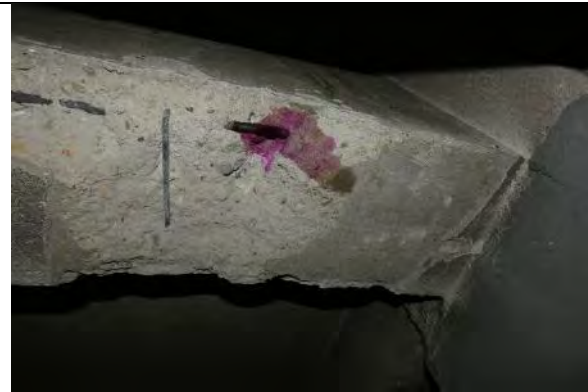
Inercarea ALC17 grinda - grosime strat beton carbonatat: 0-20mm
