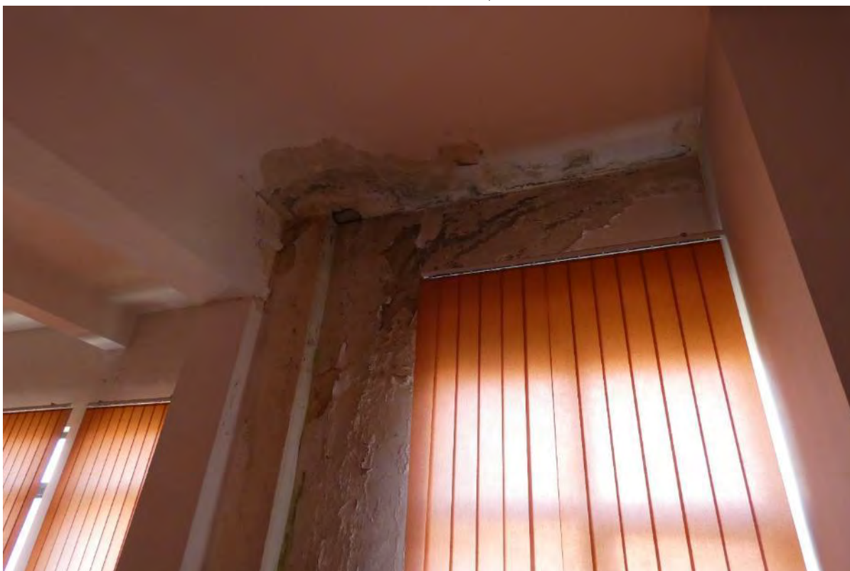
Foto 32 – Infiltratii de umiditate
