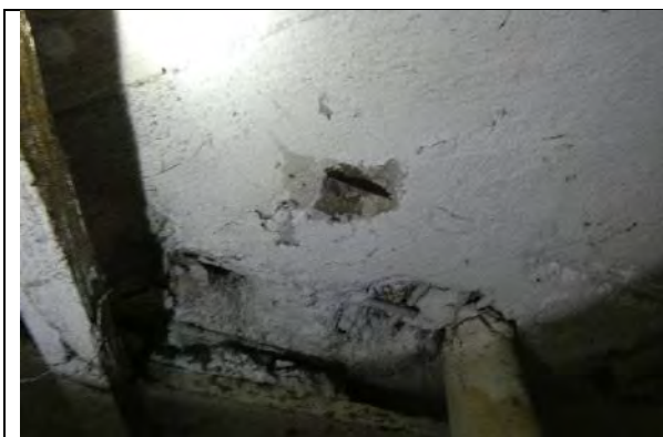
Incercarea ALC01 placa - grosime strat beton carbonatat: 0-40mm
