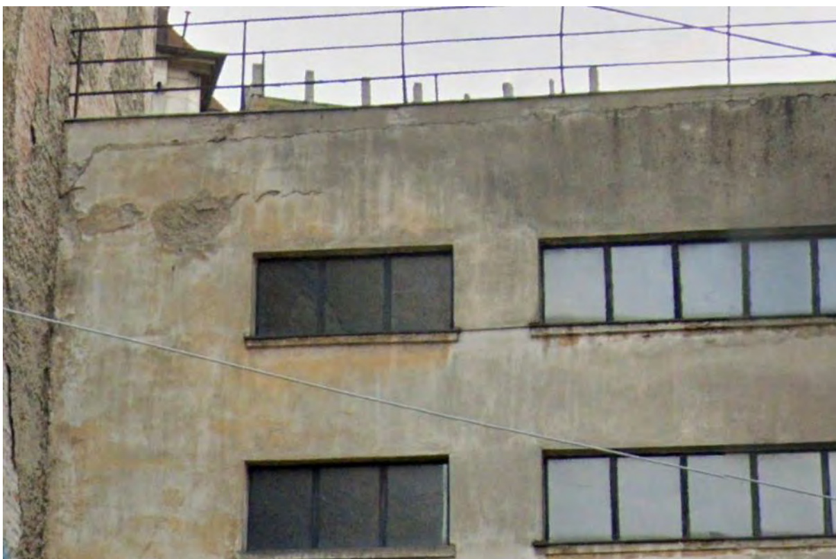
Foto 02 – Tencuieli degradate, fisuri orizontale la partea superioara a peretilor
