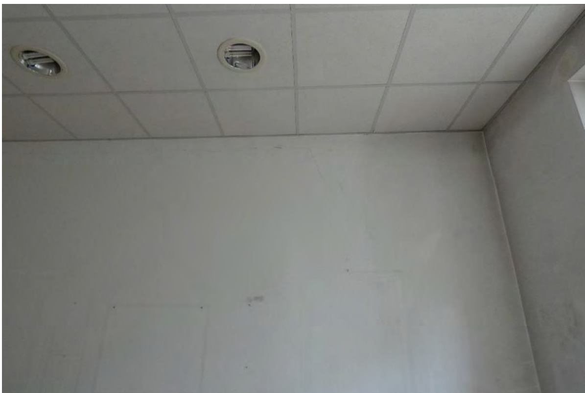
Foto 31 – Fracturi inclinate in peretii interiori
