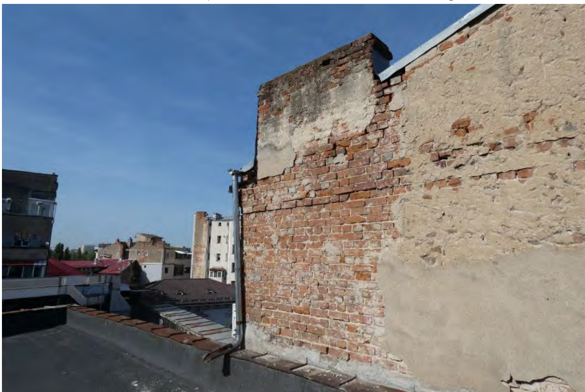
Foto 12 – Cosuri de fum existente ale cladirilor vecine avariate cu posibilitate de rasturnare peste acoperisul tronsonului C
