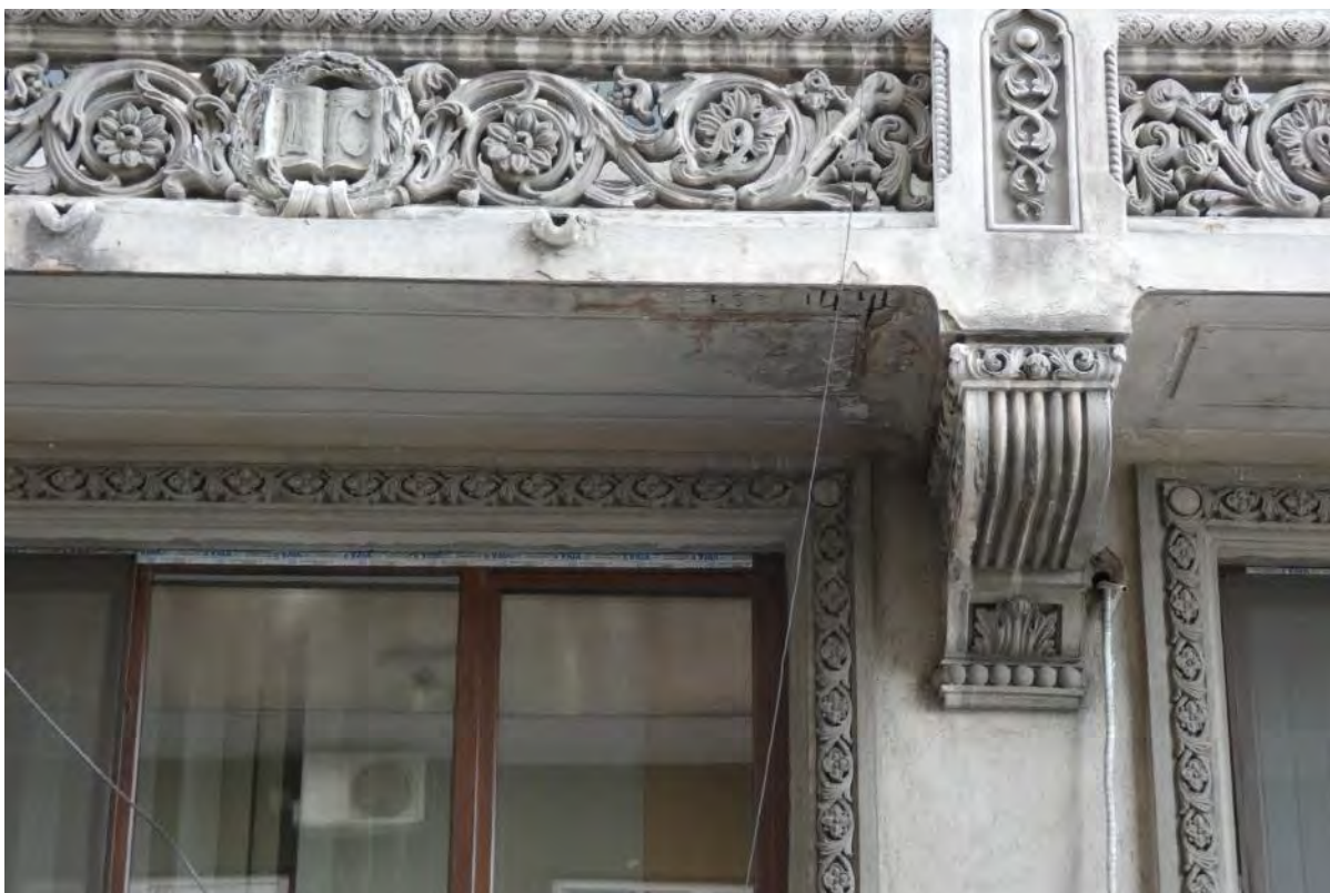
Foto 03 – Avarii la intradosul placii balconului. Infiltratii de umiditate, beton friabilizat si expulzat, armaturi expuse si corodate
