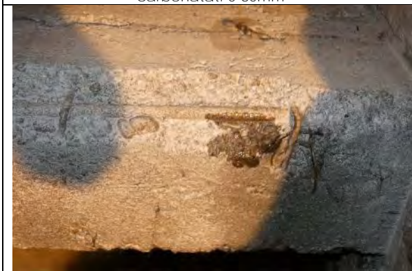
Incercarea ALC07 grinda - grosime strat beton carbonatat: 0-40mm
