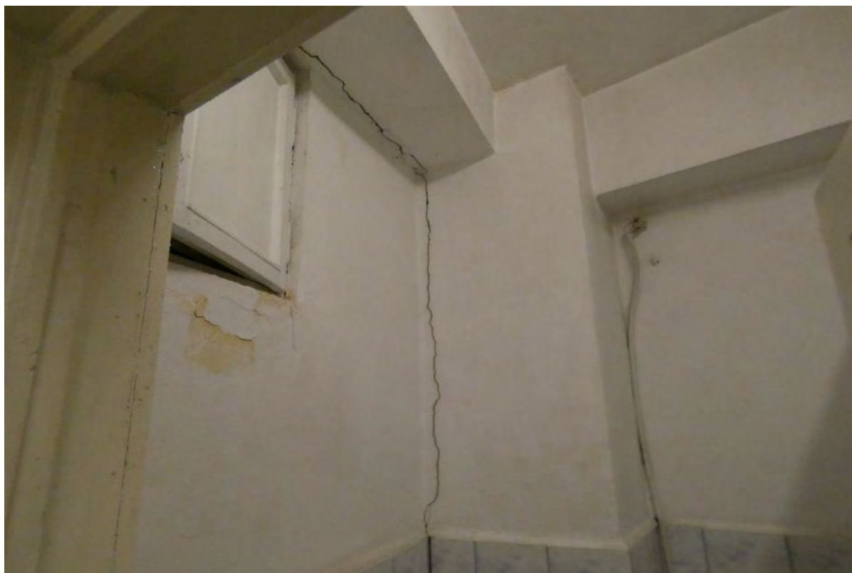
Foto 13 – Crapaturi in zona de rost dintre tronsoanele B si C . Infiltratii de umiditate
