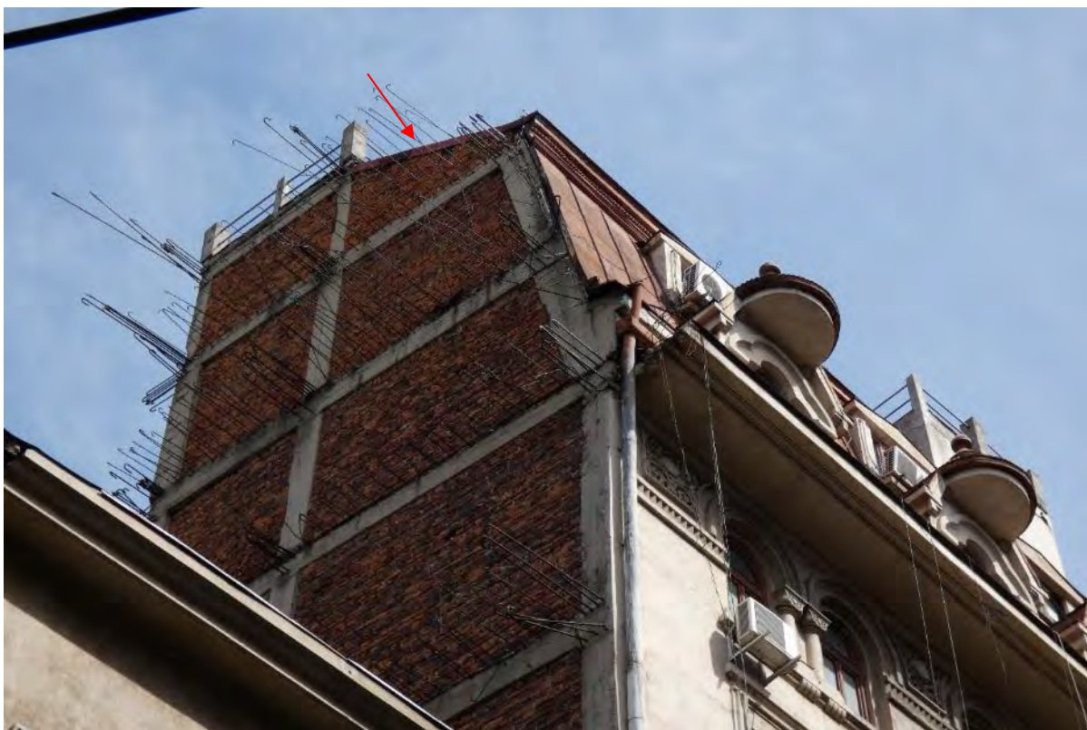
Foto 05 – Armături expuse și corodate în dreptul calcanului dintre tronsoanele A și B. Centura peste peretele atic inexistentă
