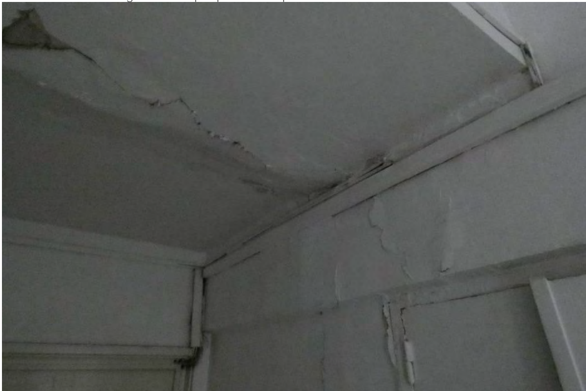
Foto 12 – Crapaturi in zona de rost dintre tronsoanele B si C
