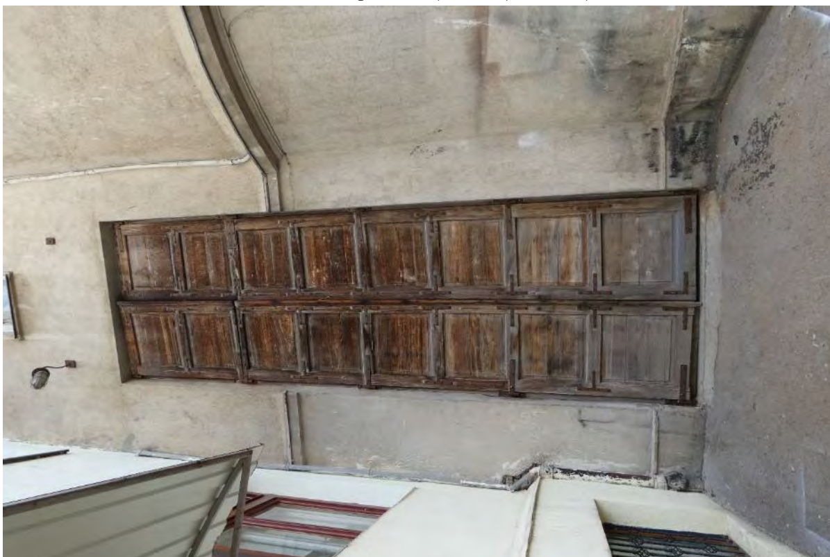
Foto 10 – Acces in imobil – degradari locale ale tamplariei
