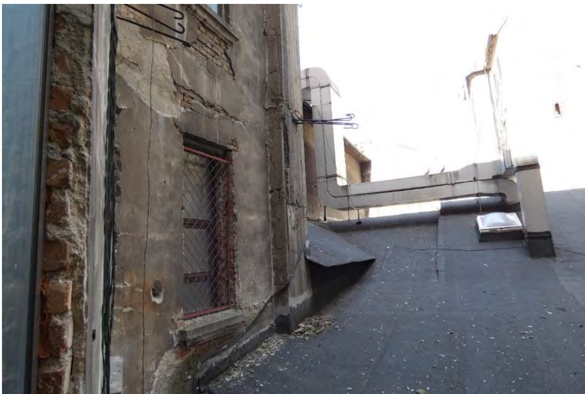
Foto 23 – Erori de executie elemente din beton armat – segregari, abateri de la verticalitate, acoperire cu beton insuficienta
