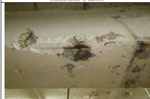
Incercarea ALC03 grinda - grosime strat beton carbonatat: 0-50mm
