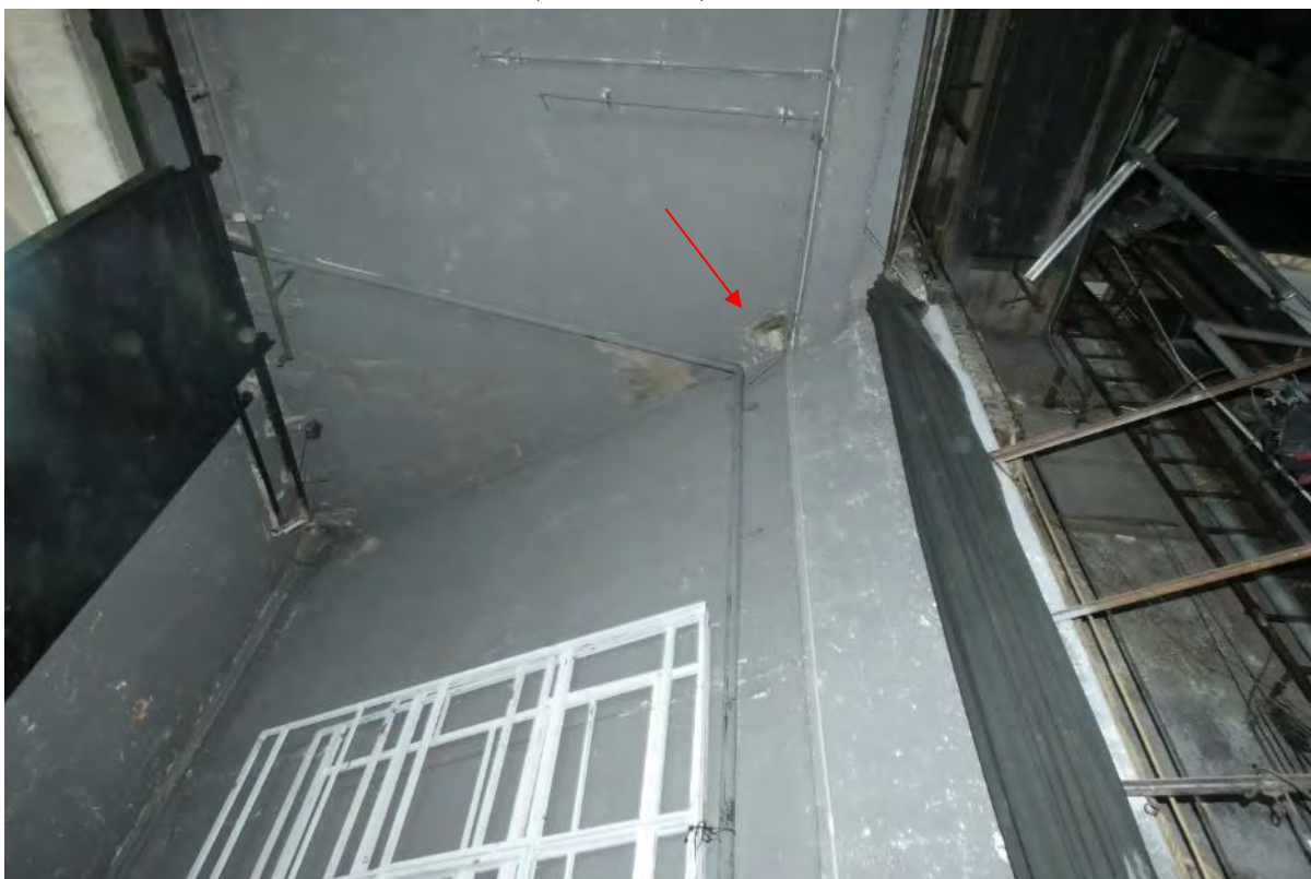
Foto 04 – Degradari la intradosul planseului peste parter
