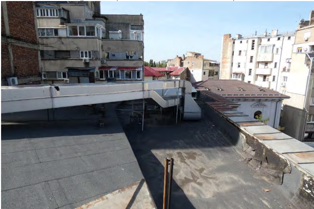
Foto 06 – Invelitoarea bituminoasa avariata. Local se observa portiuni unde apa stagneaza pe acoperis
