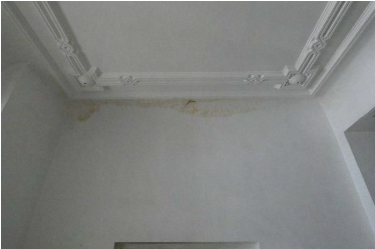
Foto 27 – Infiltratii de umiditate la nivelul planseului peste parter
