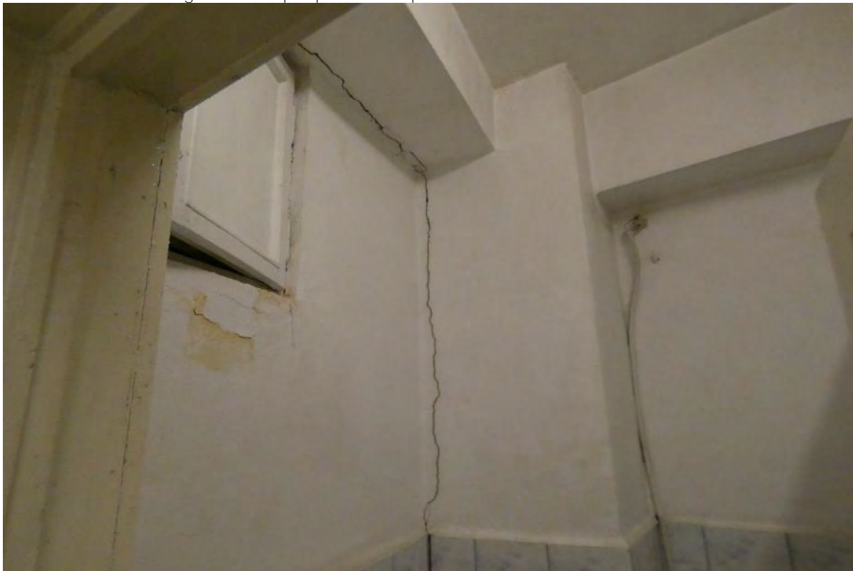
Foto 10 – Crapaturi in zona de rost dintre tronsoanele B si C
