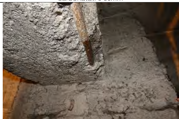
Incercarea ALC06 grinda - grosime strat beton carbonatat: 0-40mm
