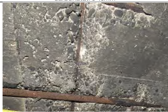
Incercarea ALC08 placa - grosime strat beton carbonatat: 0-20mm
