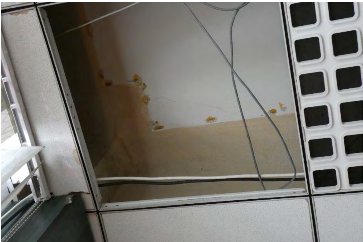
Foto 28 – Fisuri in placa planseului de peste parter
