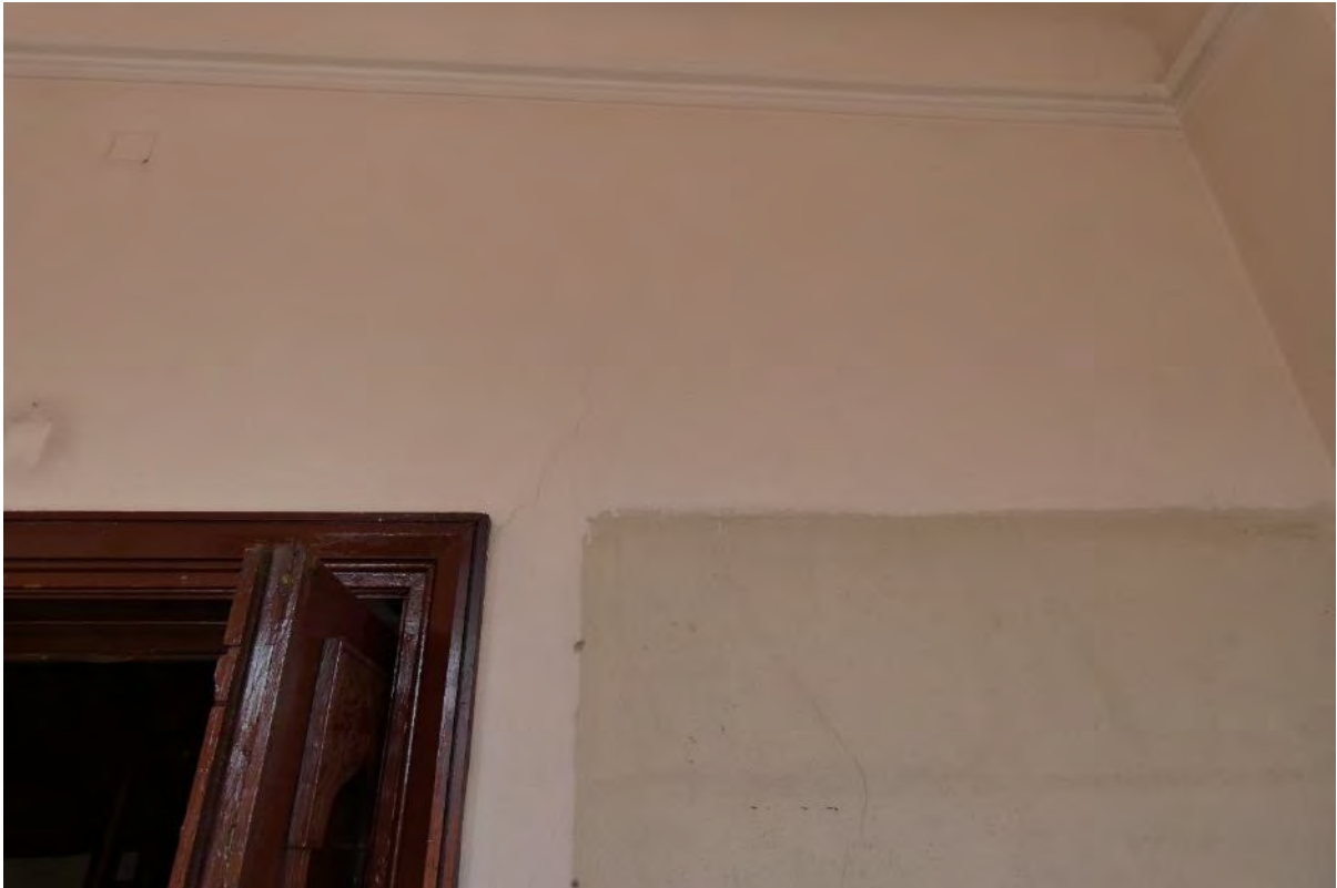
Foto 29 – Fisuri inclinate in coltul golului de usa
