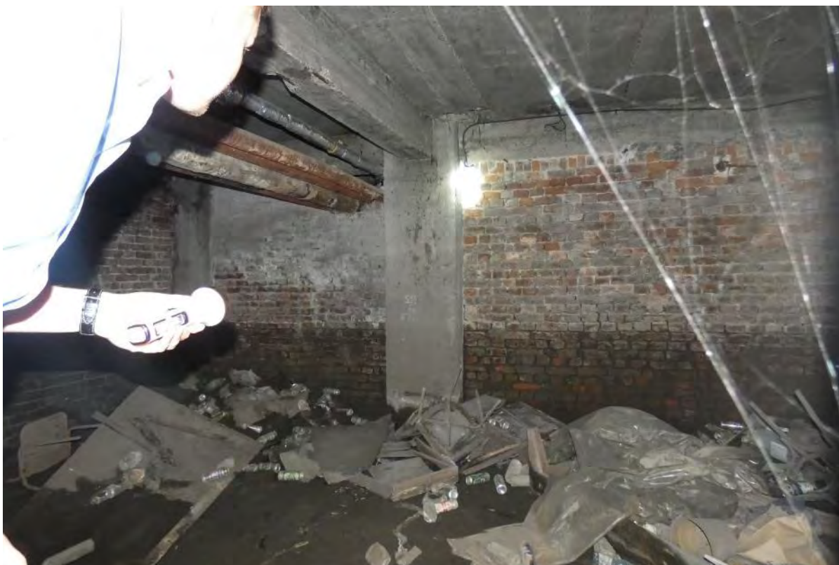
Foto 25 – Infiltratii de umiditate la nivelul subsolului cu ascensiuni in dreptul peretilor din zidarie de caramida
