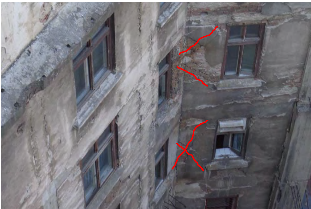
Foto 17 – Fracturi inclinate in dreptul peretilor exteriori
