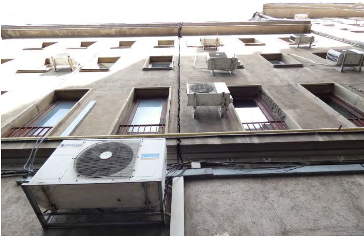
Foto 02 – Degradari in dreptul rostului structural dintre tronsoanele B-C
