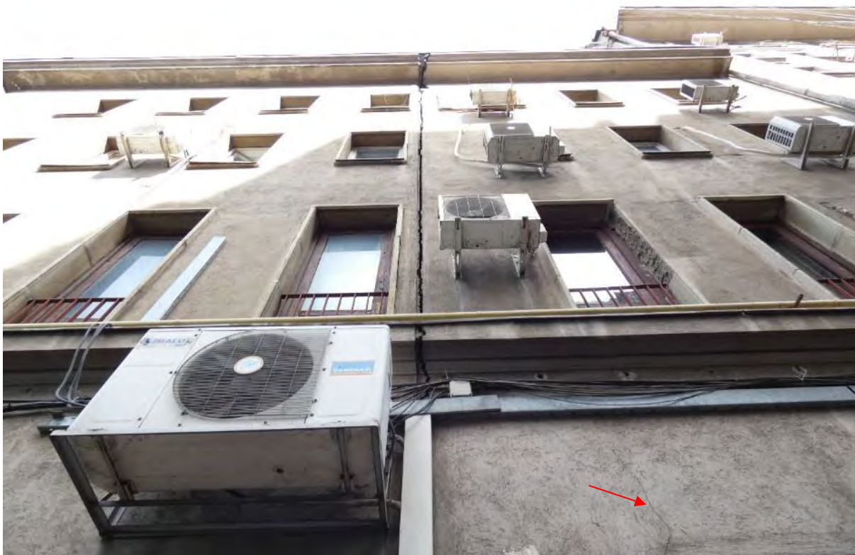
Foto 02 – Degradari in dreptul rostului structural dintre tronsoanele B-C. Fisuri verticale
