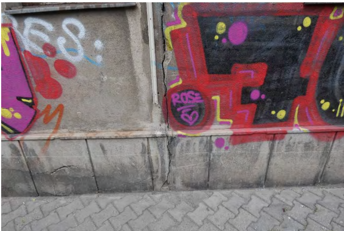
Foto 03 – Degradari in dreptul rostului structural dintre tronsoanele B si C
