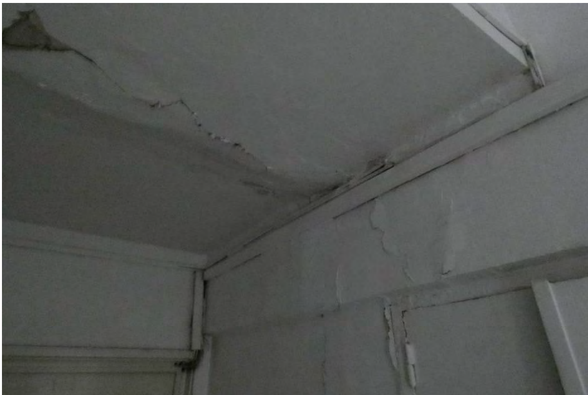
Foto 09 – Degradari in dreptul peretilor si al planseului in zona de rost dintre tronsoanele B si C
