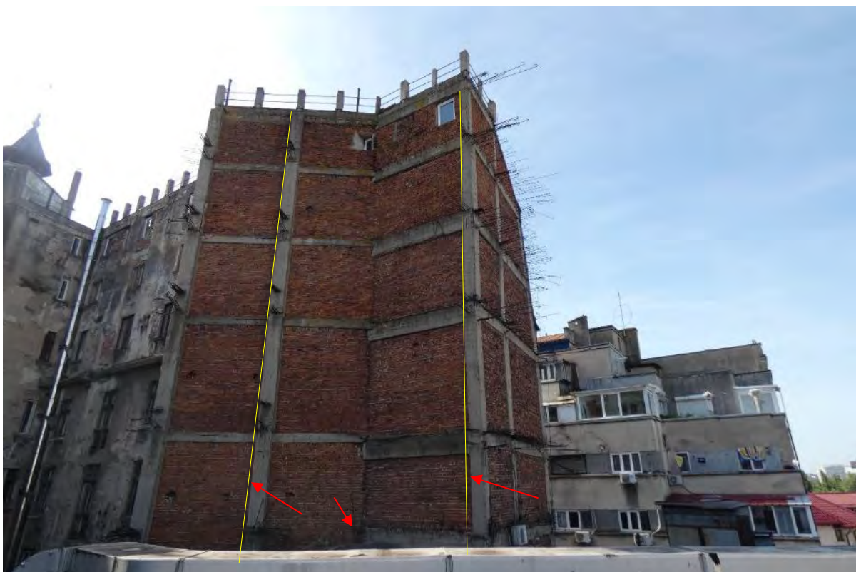
Foto 15 – Continutarea si asocierea grinzilor neconforma. Abateri semnificative de la verticalitate in dreptul stalpilor din beton armat aparenti
