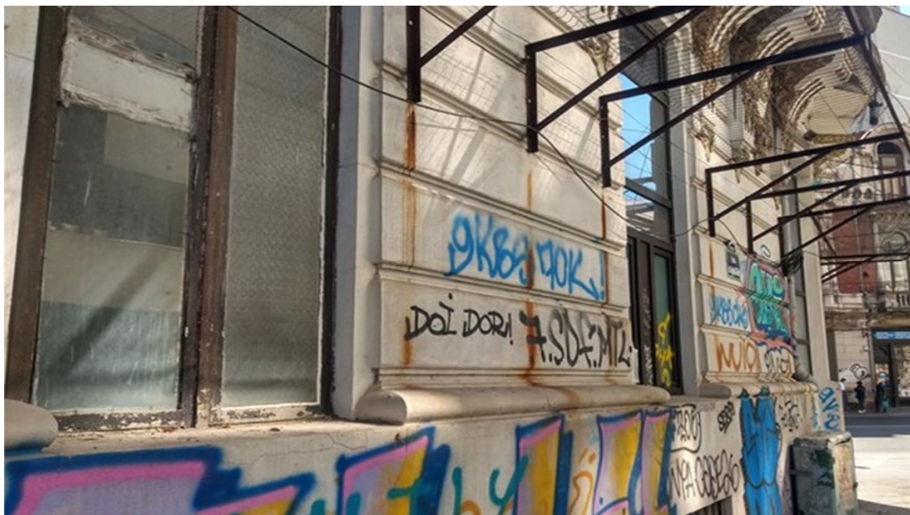
Perete exterior cu tencuiala deteriorată
