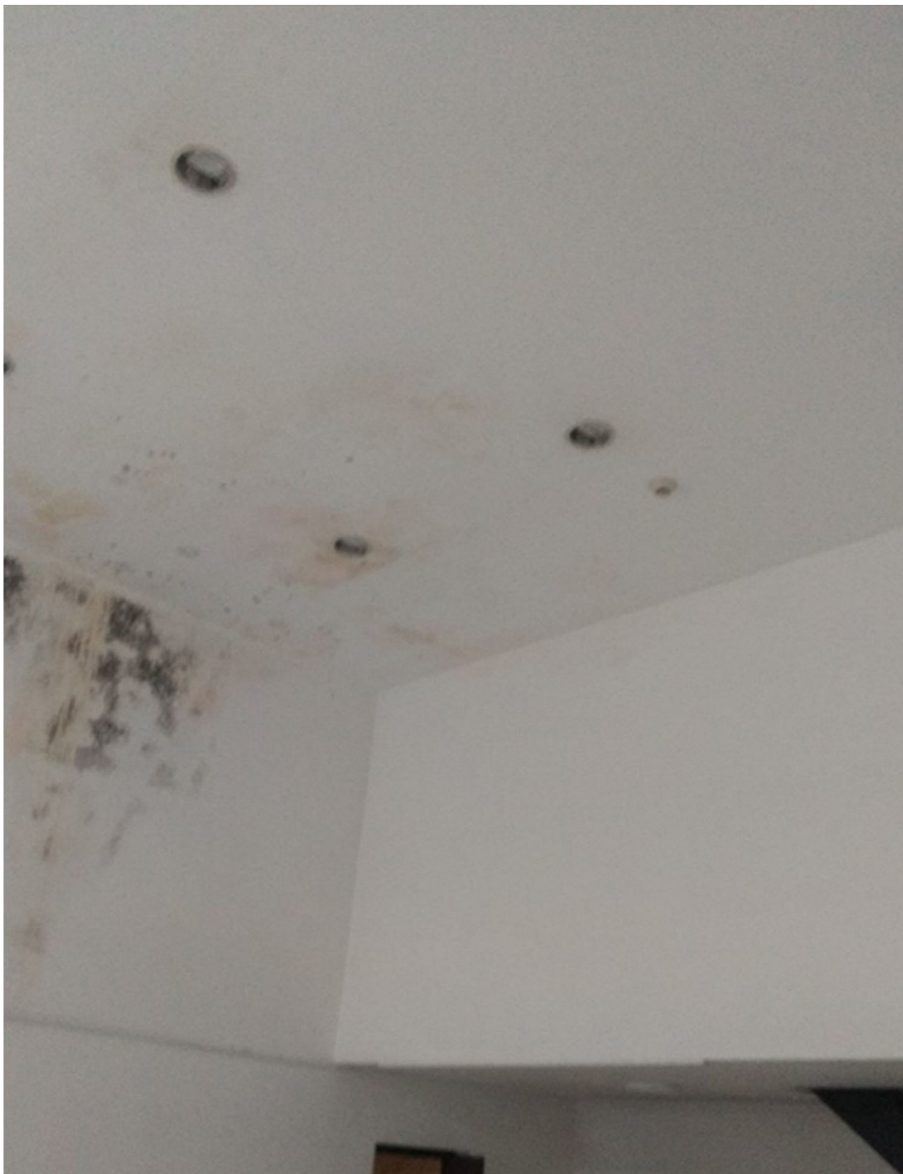
Perete afectat datorita inundarii de la etajele superioara provocata de instalatia defecta
