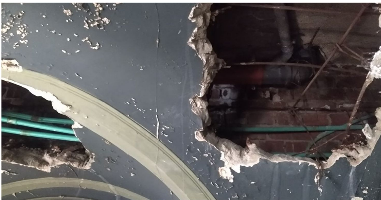
Instalatie electrica deteriorata
