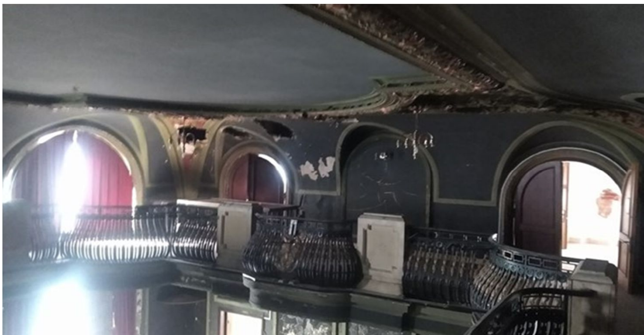
Ornamente pereti teatru afectate de inundatiile instalatiilor sanitare de la apartamentele situate deasupra
