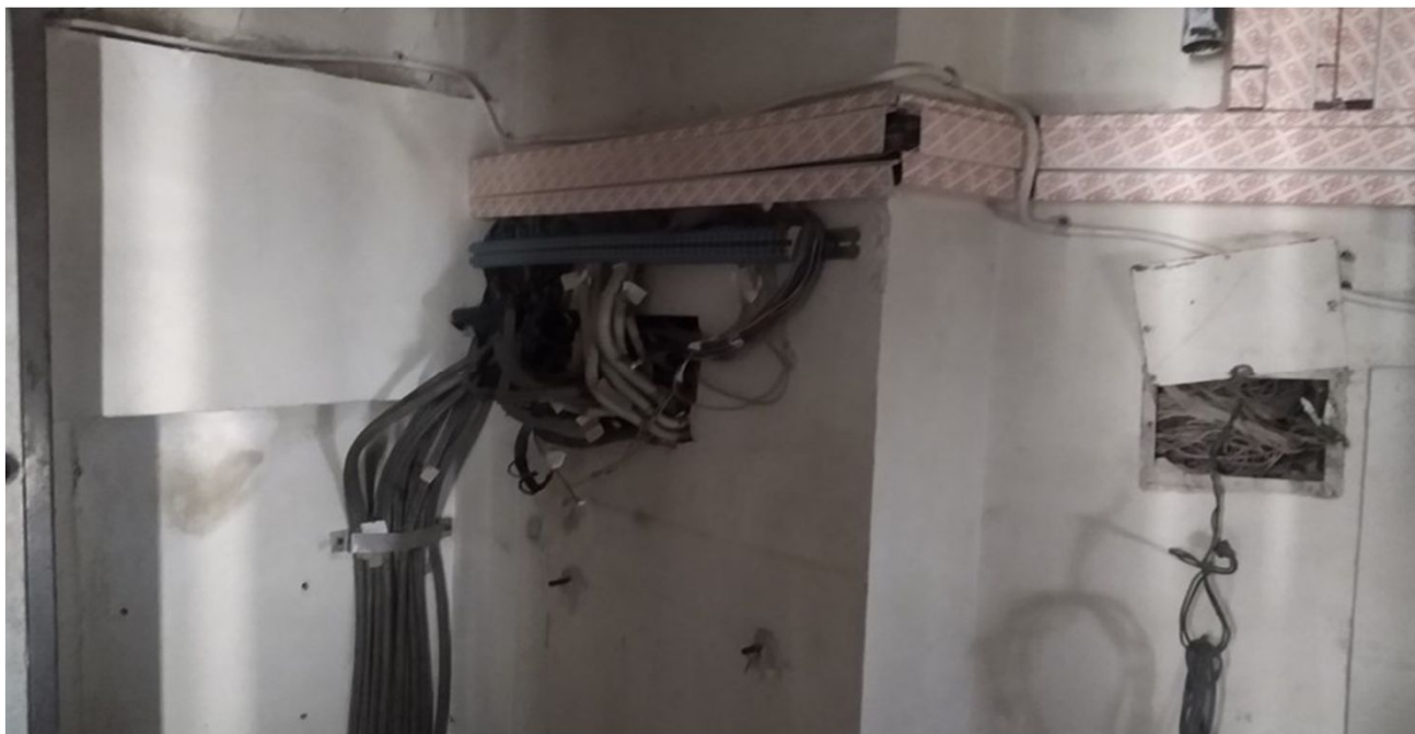
Instalatie electrica deteriorata
