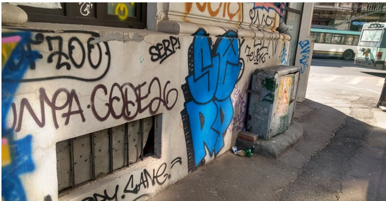
Perete exterior cu tencuiala deteriorată; ferestre lipsa la subsol
