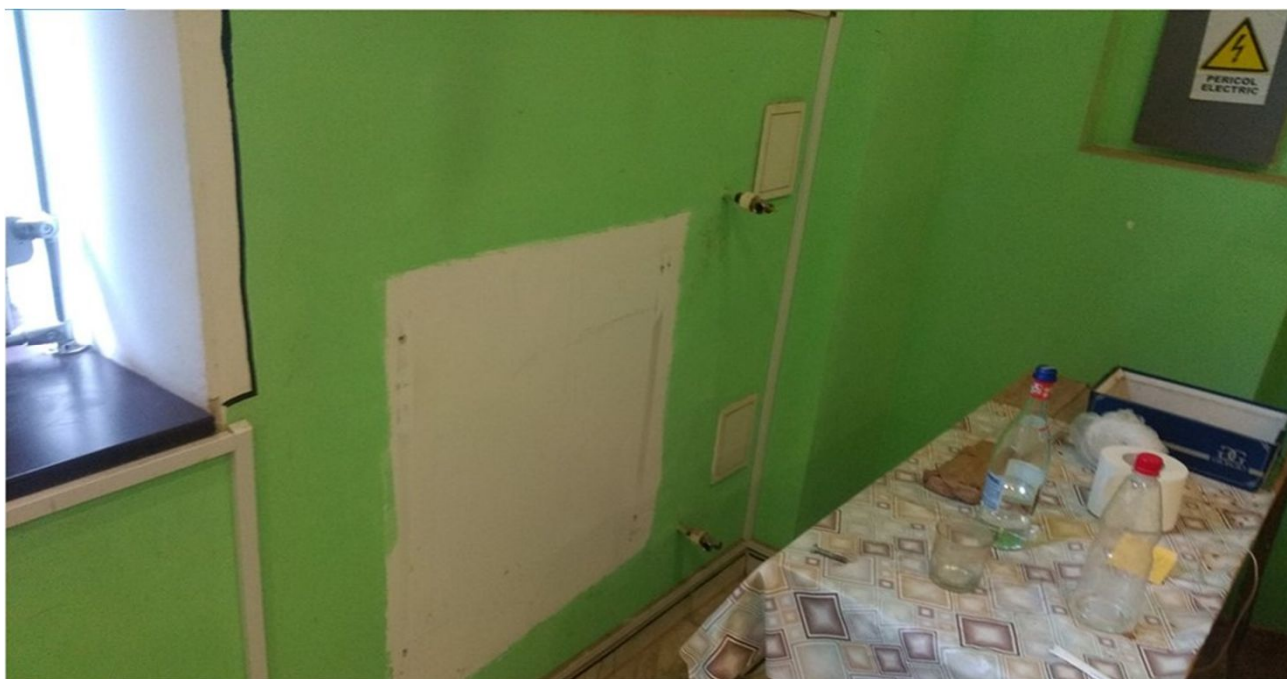
instalatie de incalzire: calorifere lipsa si defecte
