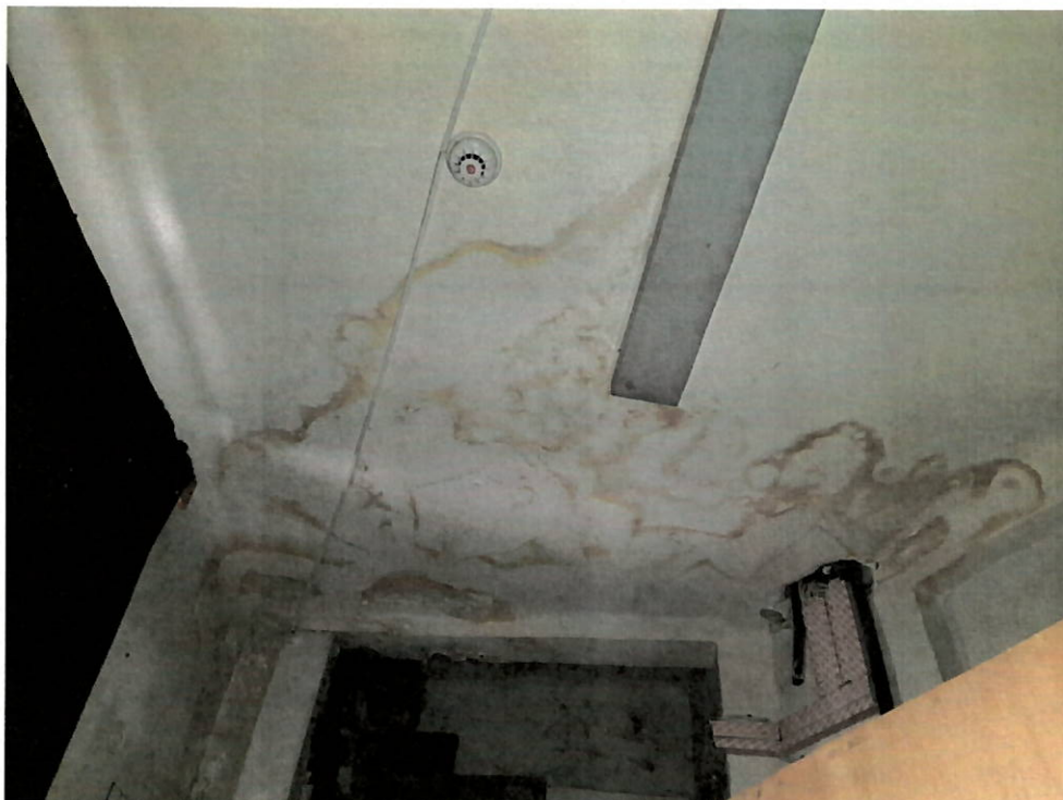
Foto 18 – camera sunet (infiltratii, posibil din pierderi de apa ale instalatiei sanitare)
