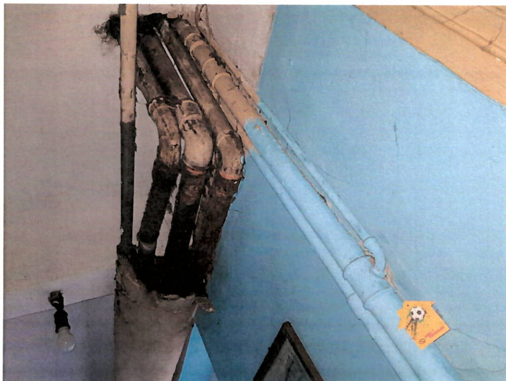
Foto 30 – instalatii incalzire (stare de coroziune avansata)
