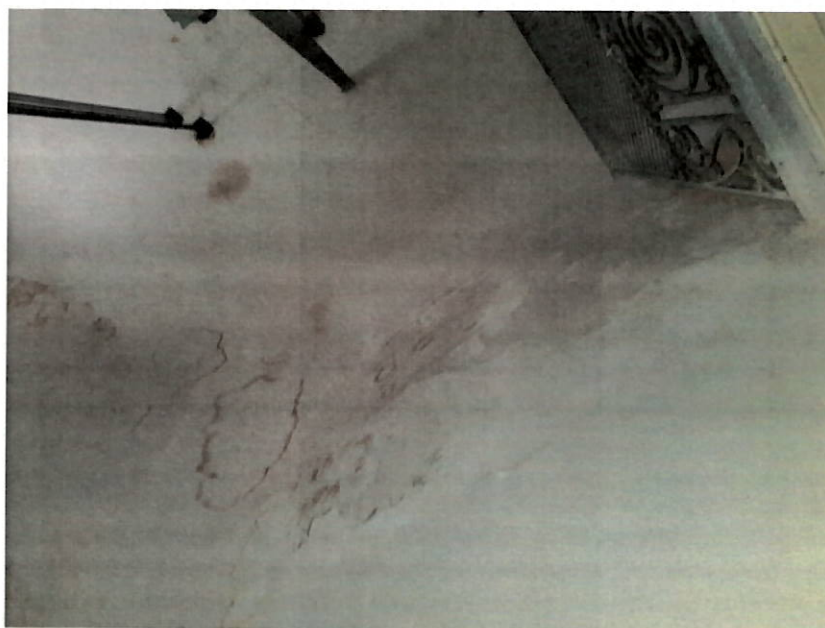
Foto 27 – casa scarii spre apartamente, ultimul nivel (infiltratii)
