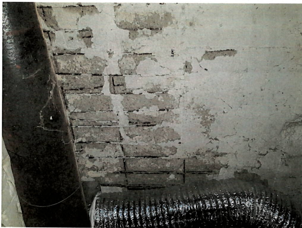
Foto 10 – subsol, culoar central (armatura inferioara expusa la planseu)
