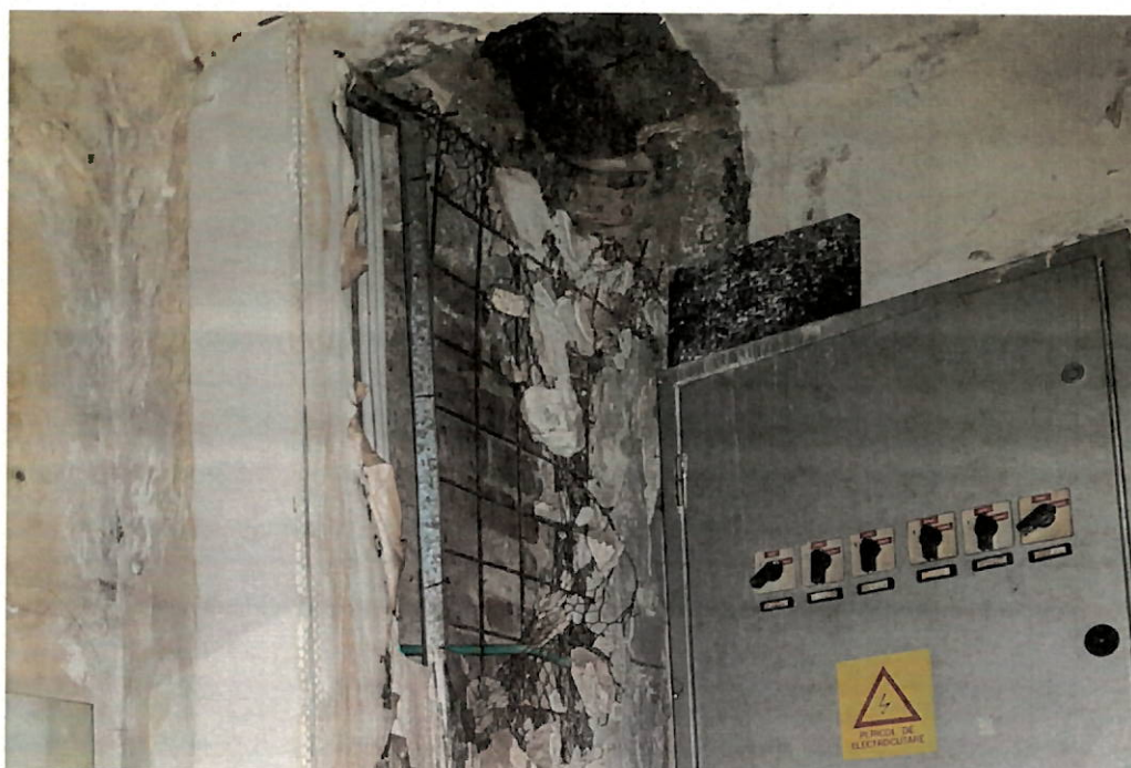
Foto 31 – instalatii sanitare (stare coroziune avansata) ; tablouri electrice initiale
