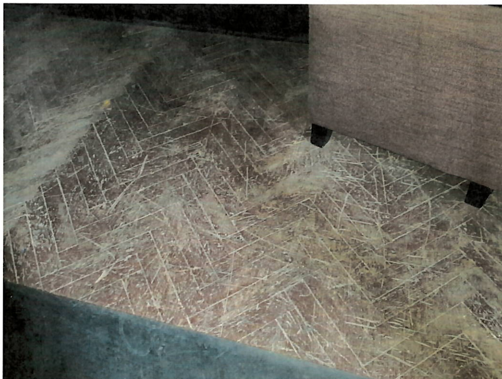
Foto 16 – sala spectacol (stare de uzura pardoseala lemn)
