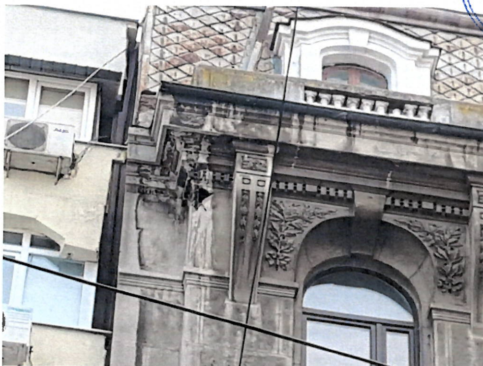
Foto 2 – fatada dinspre strada Jean Louis Calderon (spartura in tencuiala, invelitoare puternic corodată)
