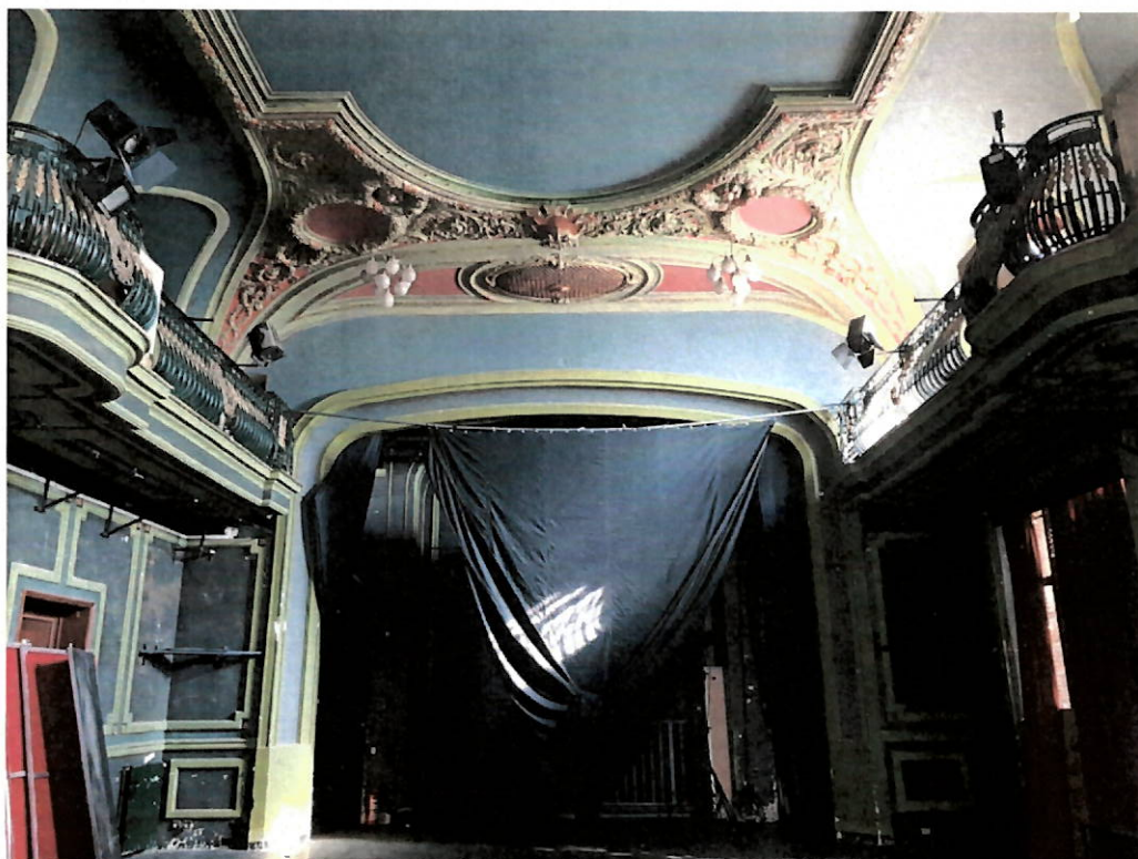
Foto 14 – sala spectacol, foto spre scena (degradari ale finisajelor)
