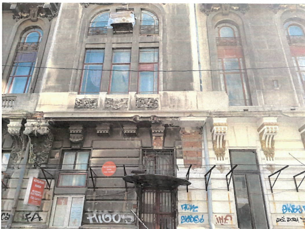
Foto 3 – fatada dinspre strada Jean Louis Calderon (elemente decorative cazute, plasa protectie pietoni)
