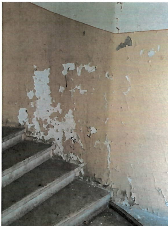
Foto 22 – casa scarii spre apartamente (degradari finisaje/tencuiala)
