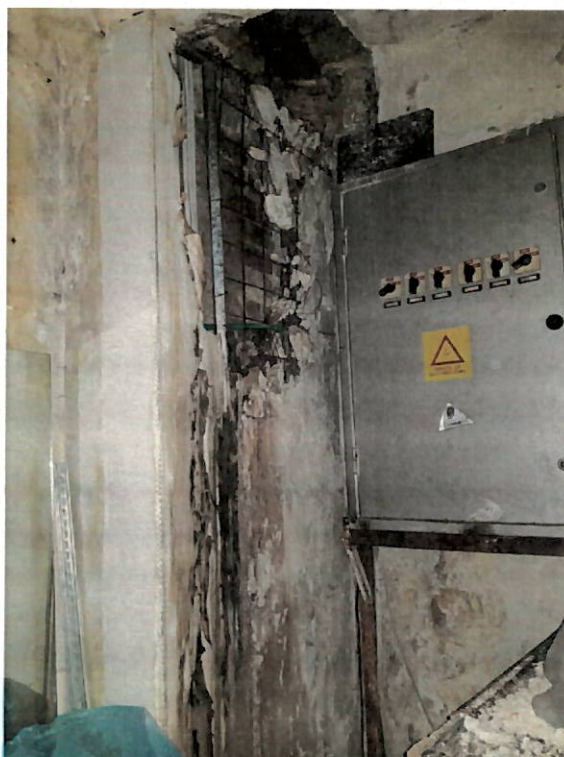
Foto 19 – camera sunet (posibil avarie anterioara a instalatiei sanitare)
