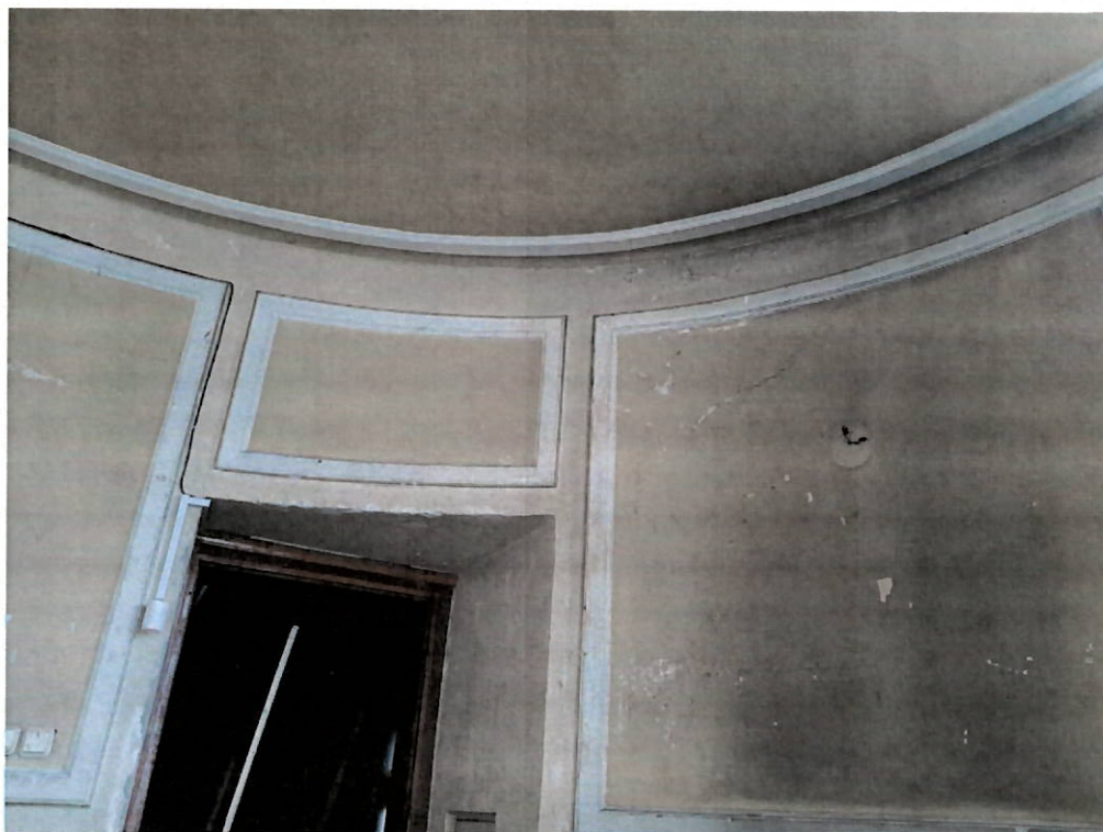
Foto 17 – camera circulara alaturata salii de spectacol (degradari, fisuri in finisaje)
