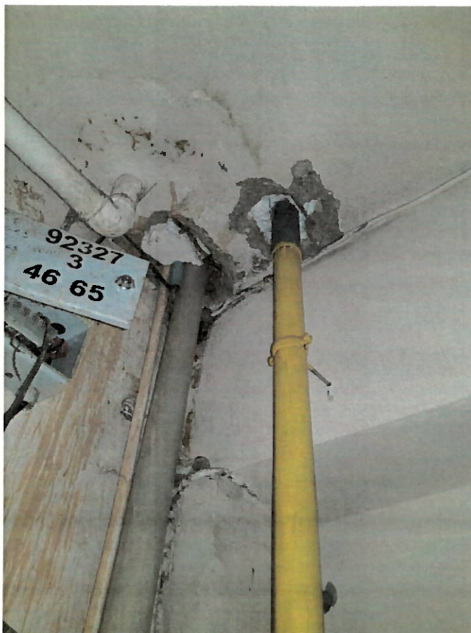
Foto 26 – casa scarii spre apartamente (goluri realizate recent pentru treceri conducte, neumplute corespunzator, armatura expusa)
