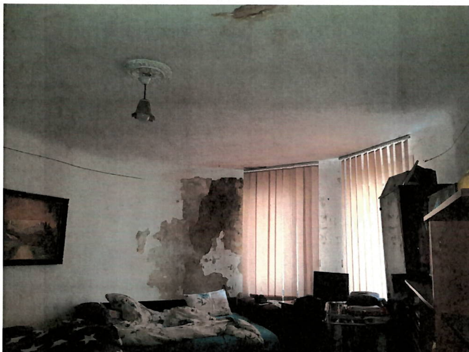
Foto 28 – apartament la ultimul nivel (infiltratii, umiditate puternica in aer)
