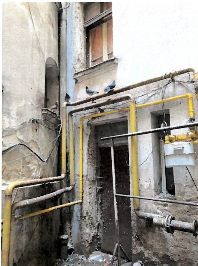
Foto 8 – fatada curte interioara (degradari ale tencuielilor exterioare)
