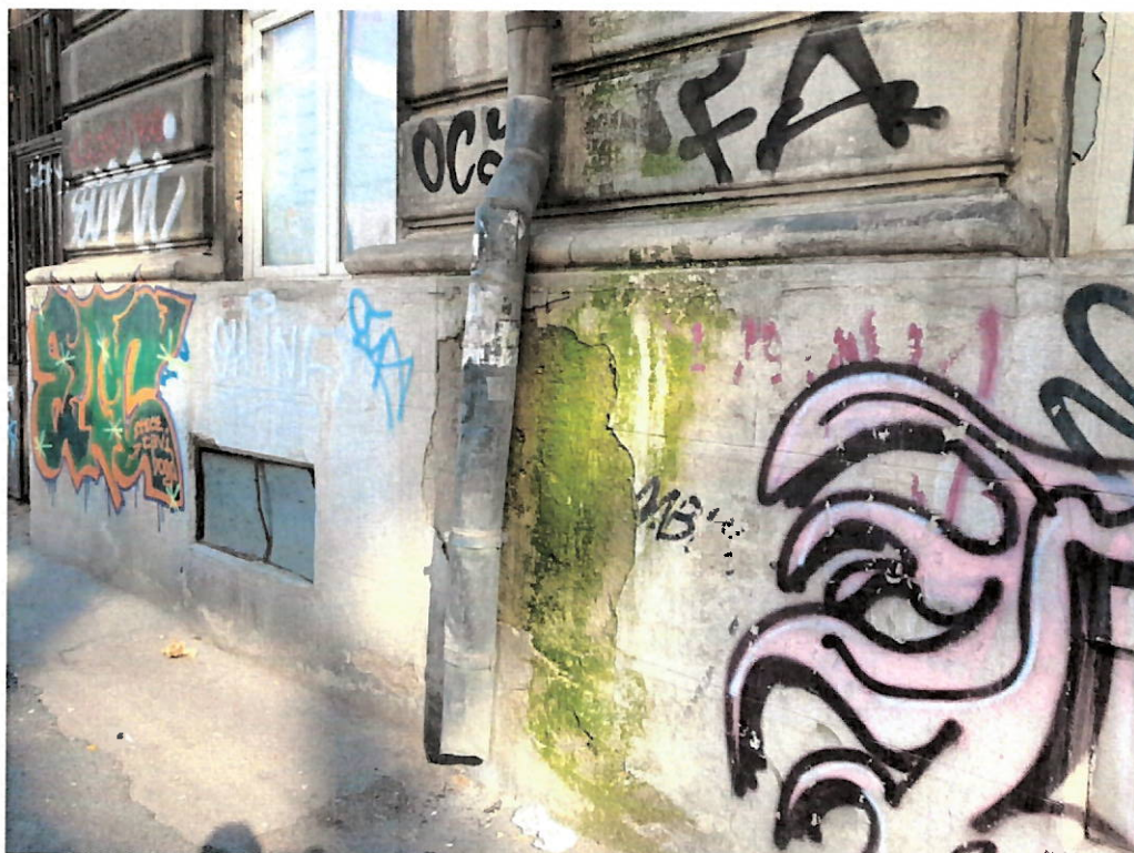
Foto 5 – fatada dinspre strada Jean Louis Calderon (tencuiala soclu desprinsa, atac biologic)
