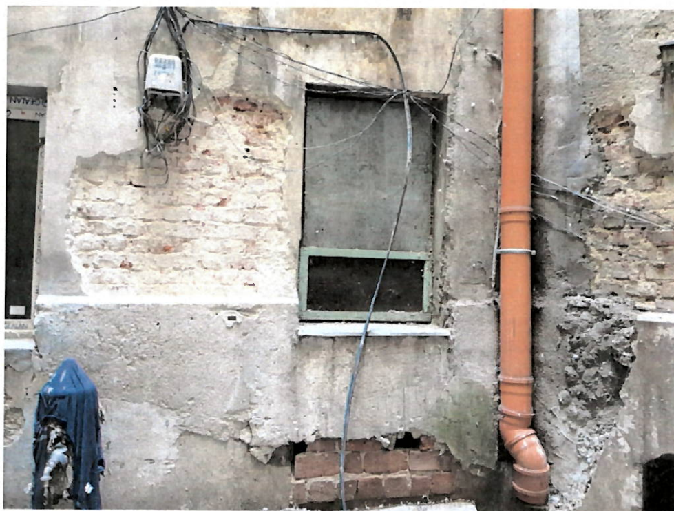
Foto 6 – fatada curte interioara (tencuieli lipsa, neaderenta, crapata, zidarie expusa)
